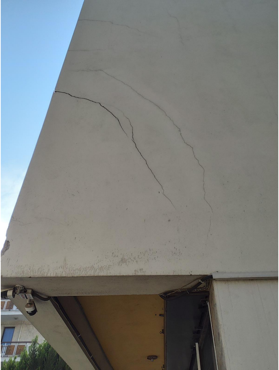
Şekil 1.17. 2020 İzmir depreminde hasar oluşan çıkmalı bir bina (Afad, 2020)
