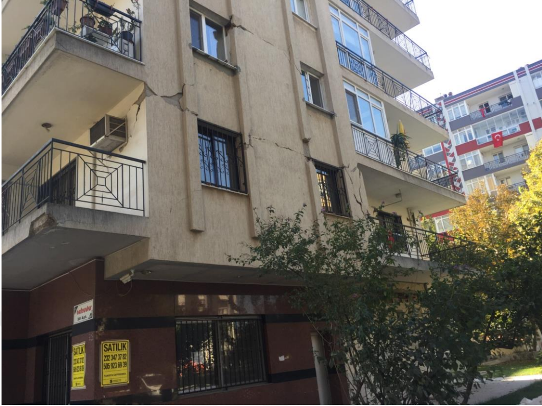
Şekil 3.2. İzmir depreminde meydana gelen deprem sonucu çıkmalarda meydana gelen hasar
