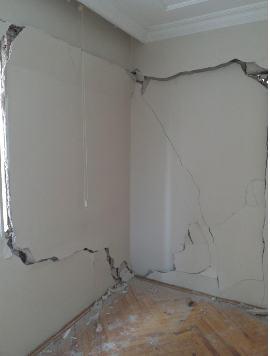
Şekil 1.18. 2020 İzmir depreminde konsolun sehim yapması sebebiyle hasar oluşan bir bina (Afad, 2020)
