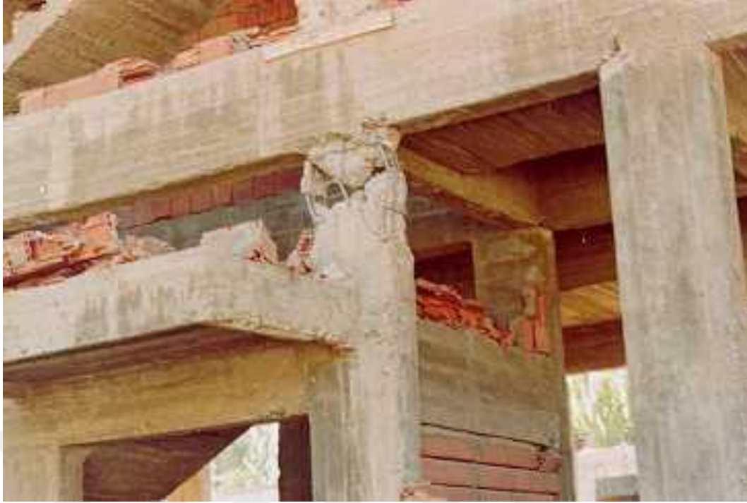
Şekil 1.23. Kısa kolon meydana gelen bir bina (Anonim, 2009a)
