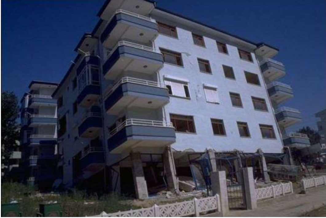
Şekil 1.21. Yumuşak kat meydana gelen bir bina (Anonim, 2021)
