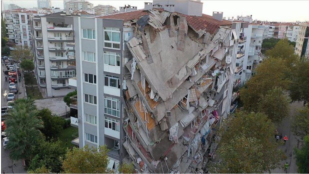
Şekil 1.5 2020 İzmir depremi sonucu yıkıma uğramış bir bina (Anonim, 2020a)
