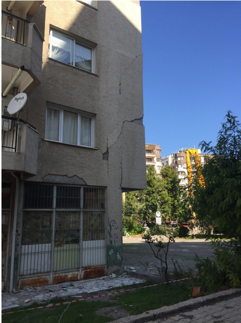
Şekil 3.1. İzmir depreminde meydana gelen deprem sonucu çıkmalarda meydana gelen hasar
