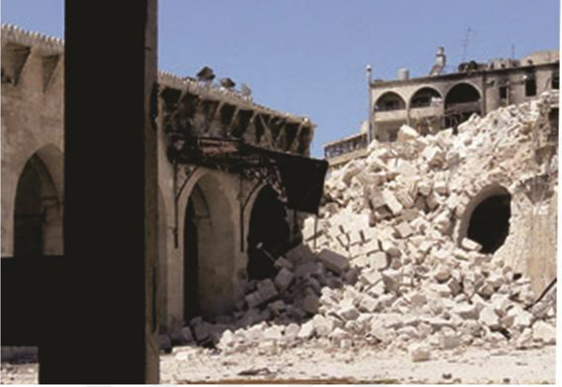
Şekil 78 Halep, Suriye Yıkım sonrası Emevi Camii'nin minaresi. (Halep Eski Eserler ve Müzeler Müdürlüğü, 2017)
