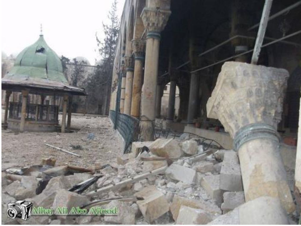
Şekil 24 Halep, Suriye Al-Adliya Camii'nde yıkım gösterileri (Suriye Mirasını Korumak, 2011)
