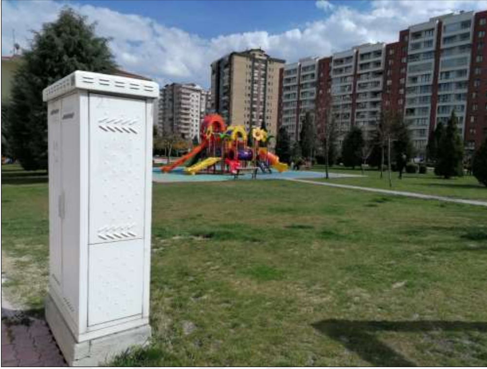
Şekil 5.44. Şefikcan Caddesinde çocuğun oyun oynadığı mekânda bulunan elektrik trafosu
