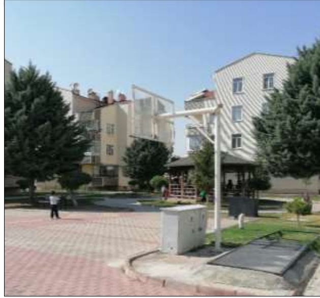
Şekil 5.38. Akasya sitesinde çocuk oyun alanında bulunan elektrik trafosu
