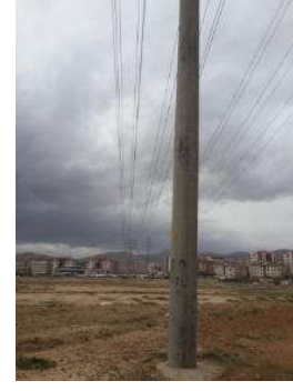
Şekil 3 ölçüm yapılan iletim hattının fotoğrafı
