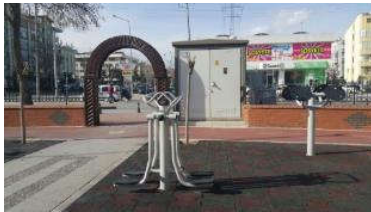
Şekil 7 (b) Ölçüm yapılan trafonun fotoğrafı
