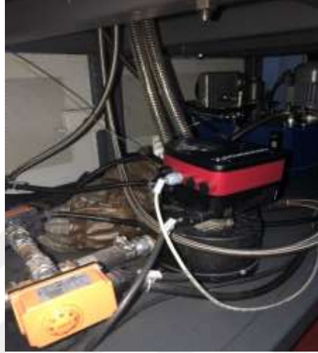
Şekil 5.11. Soğutma Suyu Besleme Ünitesi
