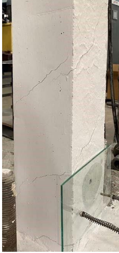
Şekil 5. Kolonda Meydana Gelen Burulma Hasarları
