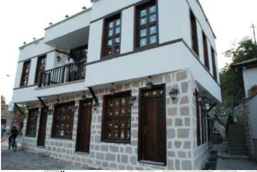
Resim 15. Özgün olmayan betonarme üzeri taş kaplama
