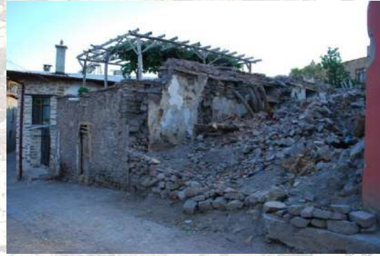
Resim 8. Yıkıldıktan Sonra Yapının Durumu
