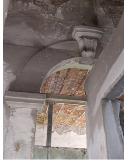
Şekil 6.34. Kapı boşluğunu kesen muhdes duvar (Fersah Mimarlık-Amasya)
