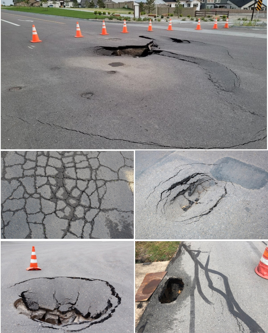
Şekil 66. Obruk belirtisi: Yollarda belirgin oturma, çatlak ve delikler ( https://americanfw.com/sinkhole-repair , 2023; Hiler ve Grewe, 2021; )
