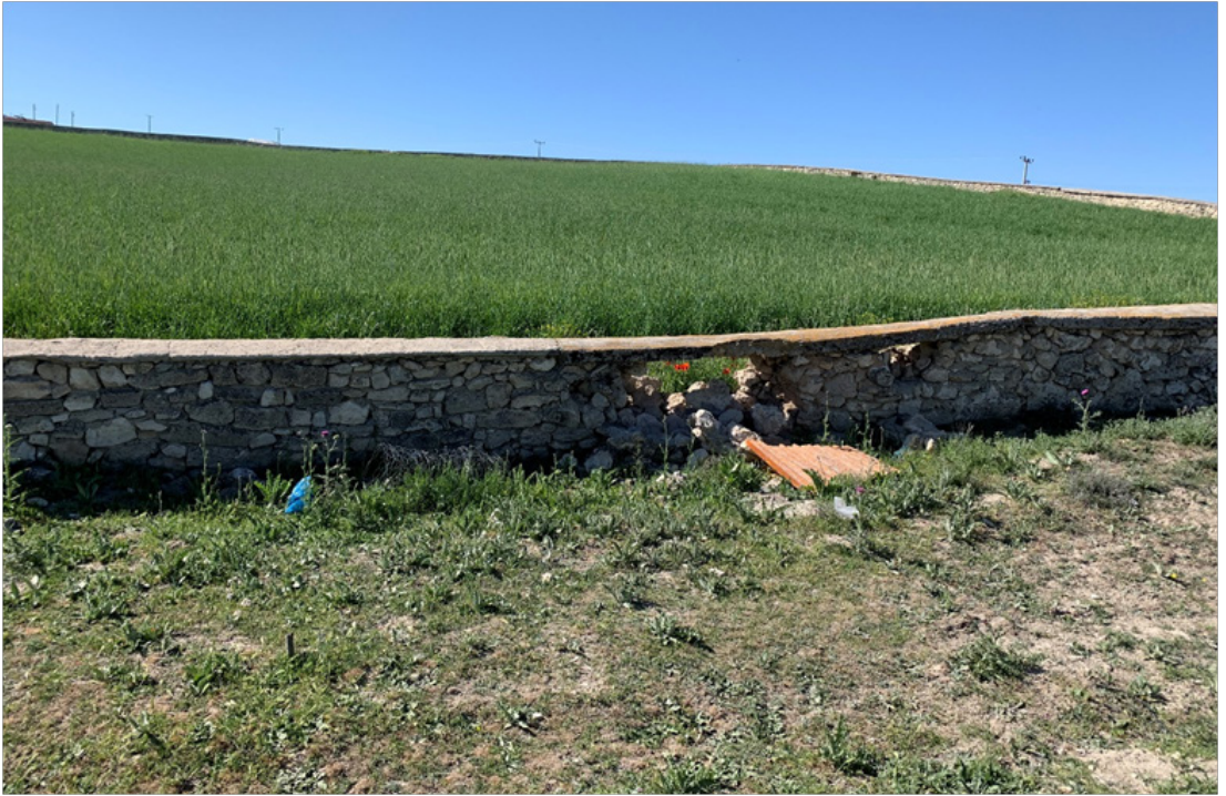
Şekil 70. Obruk belirtileri: Bahçe duvarlarında çökme, yıkılma ve dökülmeler (Arık vd, 2022)
