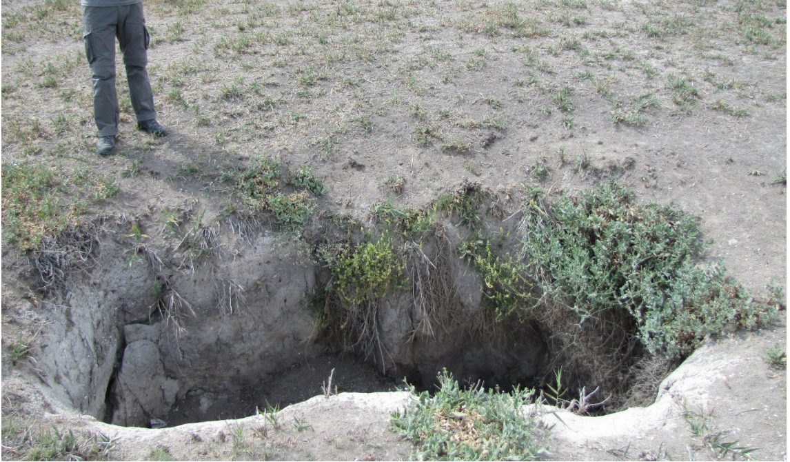
Şekil 10. Karatay (Konya) İl Merkezi yerleşim alanı doğusunda Sanayi bölgesinde oluşan bir örtü çökmesi obruğu
