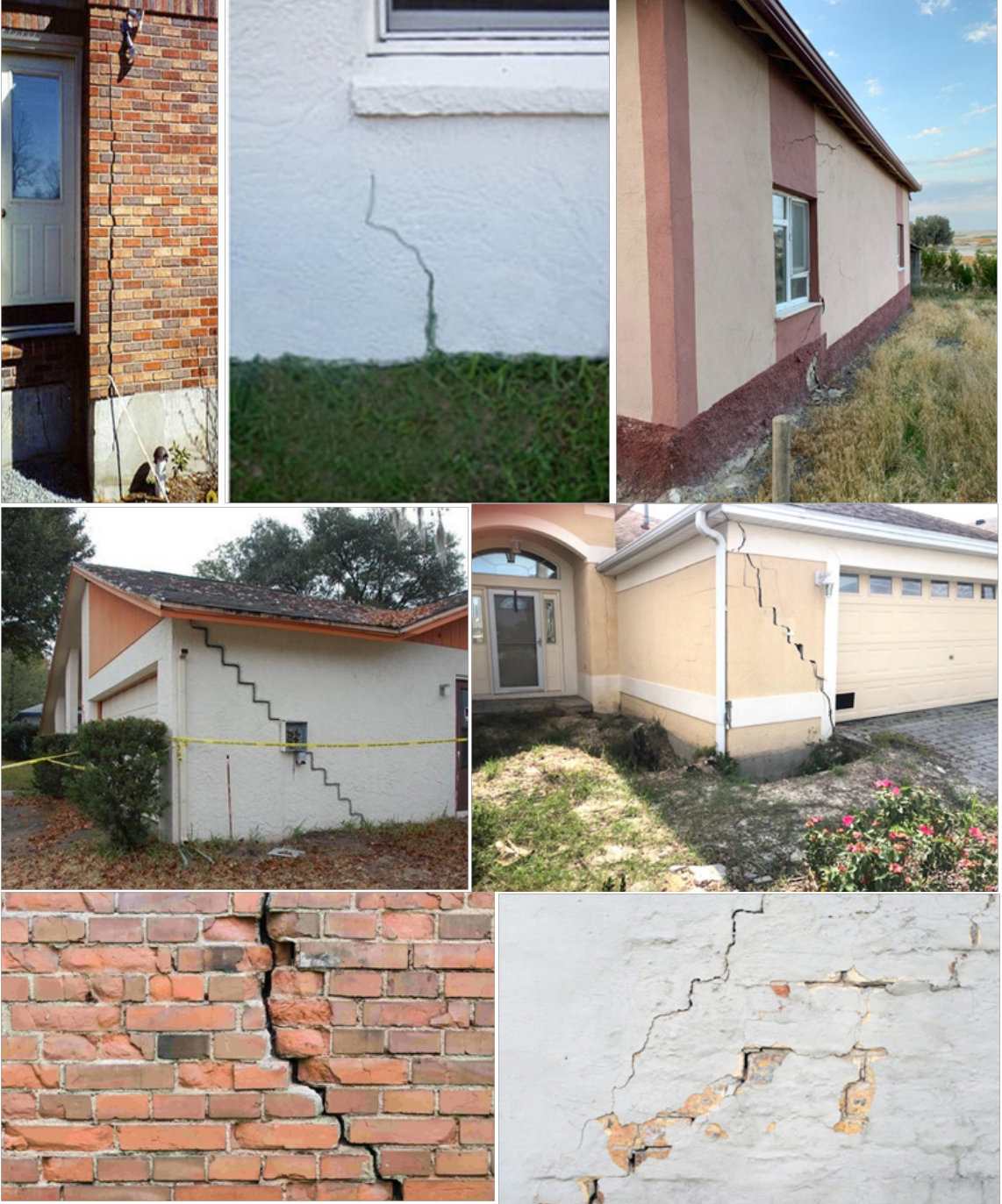
Şekil 65. Duvarlarda dikey ve merdiven basamağı şeklinde çatlaklar şeklinde Obruk belirtileri (Arik vd, 2022a ve b, ichflorida.com/claim-types/sinkhole , usgs.gov/media/images/sinkhole-activity-damages-home , villages-news.com , 2018).
