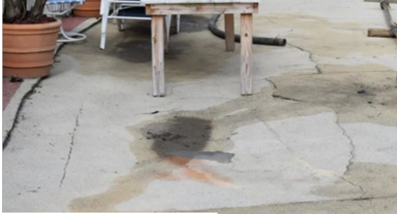
Döşemede Hafif Çökme, Kırılma Ve Su Birikintisi
