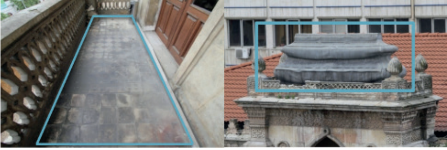
Şekil 12. Karosiman ve Kurşun Kaplamalarda Oluşan Hasarlar (Mostar-a, 2017)
