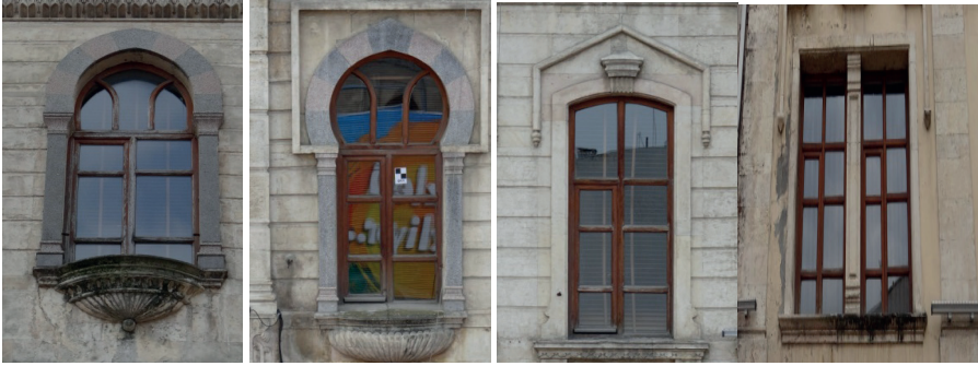
Şekil 7. Yapıdaki Pencere Tipleri ve Hasarları (Mostar-a, 2017)
