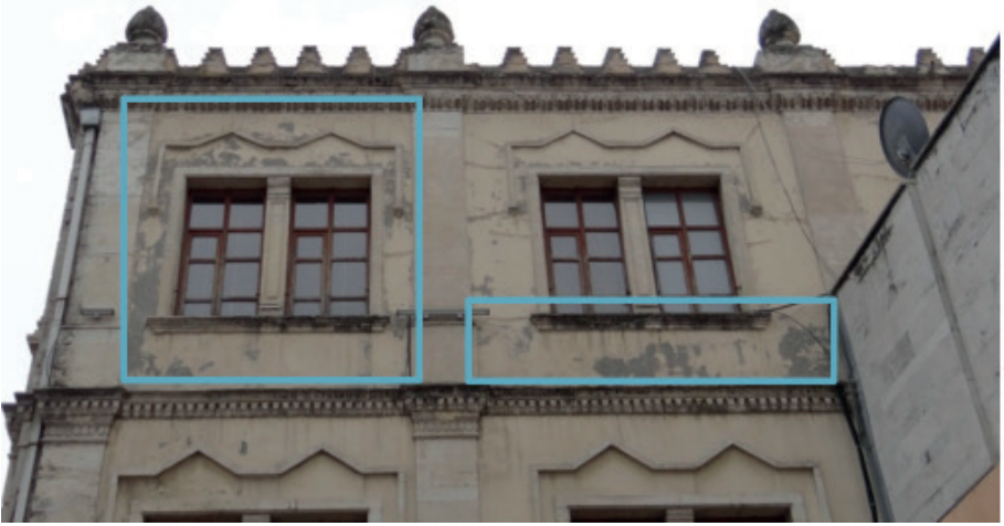
Şekil 11. Batı Cephesindeki Sıva Bozulmaları (Mostar-a, 2017)
