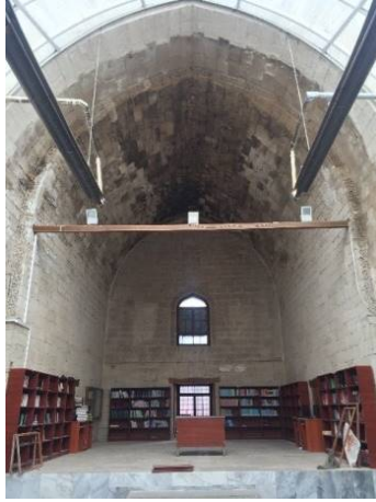
Görsel 18. Yalıtım Sorunu Nedeniyle Eyvanda Meydana Gelen Renk Değişimi
