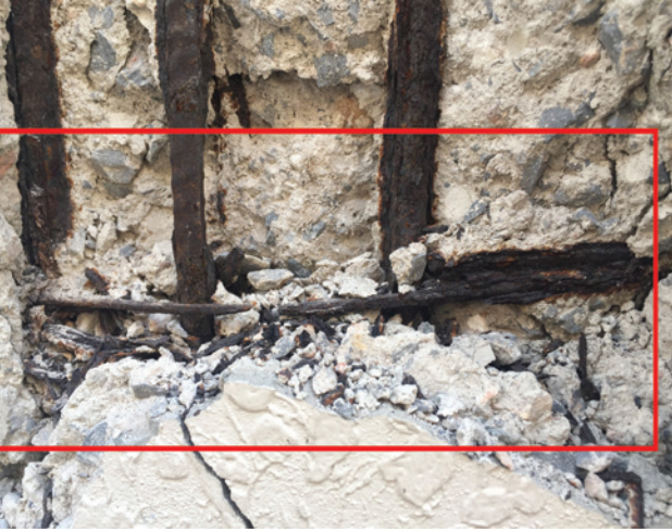
ÜSTTE İzmir depremi sonrası yıkım karar verilmiş bir yapıya ait elemanda nervürlü ve nervürsüz donatının bir arada bulunması; Ecemiş, 2020 (Resim 5)
