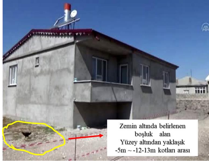
Şekil 4.9. Karapınar-Merkezde yeni yapılan yapının altında belirlenen obruk
