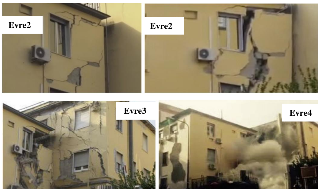
Şekil 2.13.Obruk oluşumunun başlamasından bitimine kadar ki 4 evrede oluşan bina deformasyonları (Cennamo ve ark., 2017)
