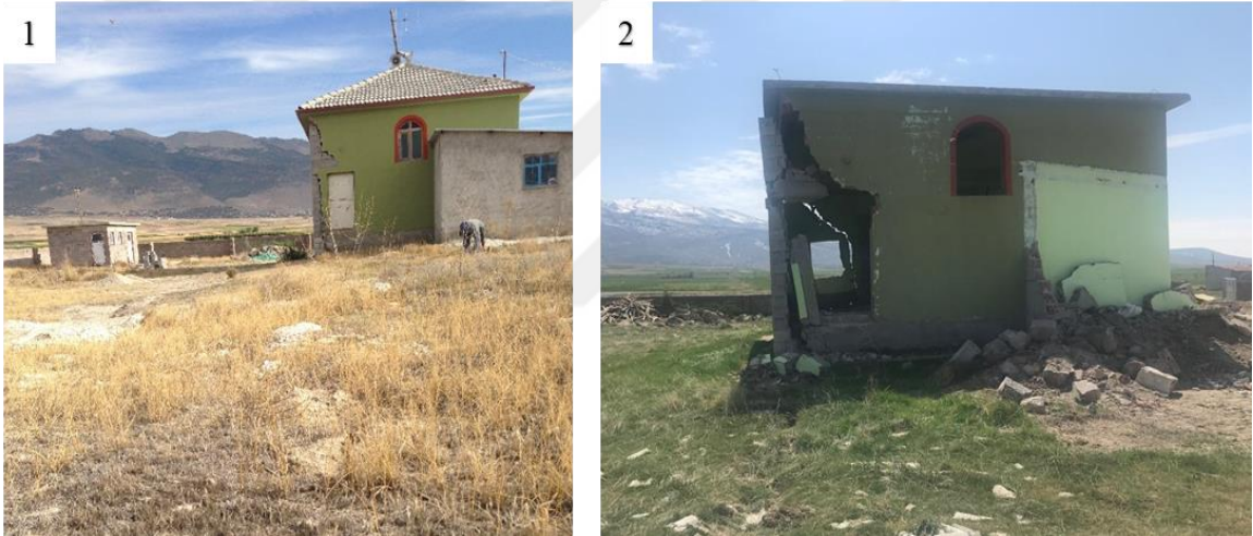
Şekil 4.8. Karapınar-Sırçalı mahallesinde obruğun zamanla oluşması ile camide yol açtığı zarar
