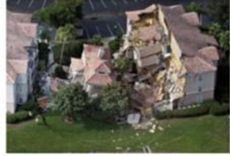
b. Filoridada Walt Disney yakınında 2013 yılında oluşan obruk
