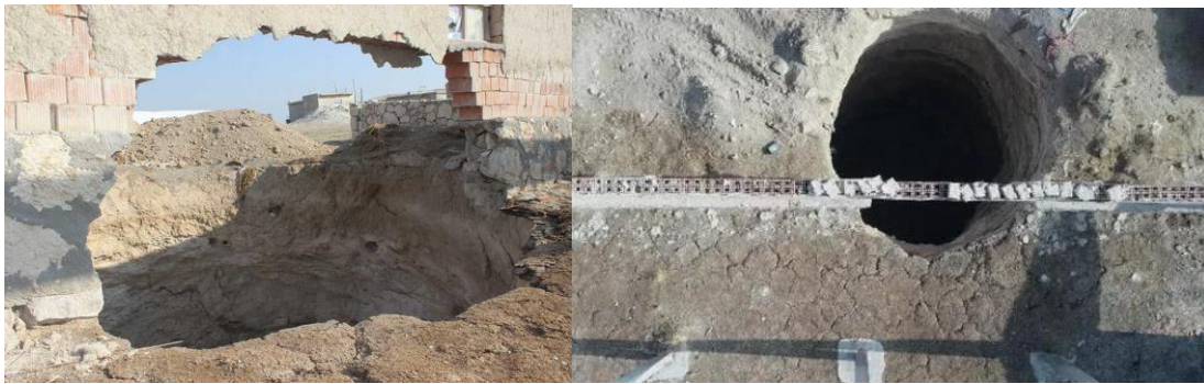
Şekil 4.10. Karapınar-Reşadiye mahallesi acarlar yaylası oluşan obruk ve duvarda meydana getirdiği çökme
