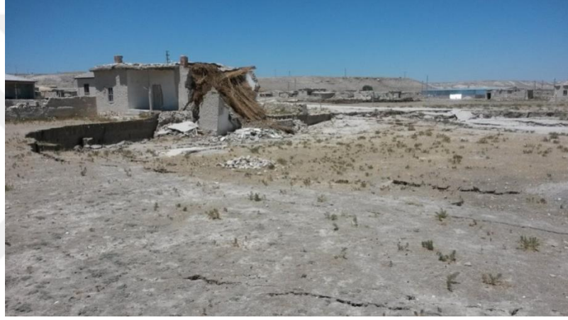
Şekil 4.6. Karapınar-Seyit Hacı Yaylasıobruğu ve zarara yol açtığı kerpiç ev
