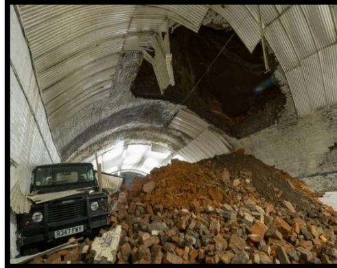
Şekil 2.6. Tavanı Çökmüş Tünel (Url.2).
