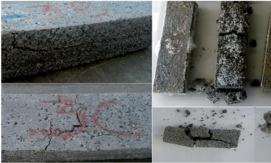
Şekil 1.3. Sülfatın beton üzerinde bozulma etkisi (Akalin T. 2010)
