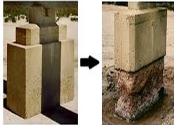
Şekil 1.1. Sülfatlı nehir suyunun uzun süreli betona etkisi (Ö.Yeniay 2022)
