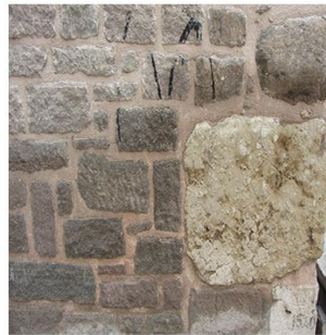
Hatalı Malzeme Kullanımı (Karatay Medresesi)
