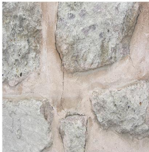
Çatlama (Ak Camii)
