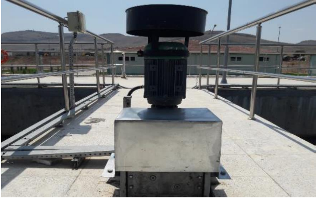
Şekil 3.7. Mavi Tünel İçme Suyu Arıtma Tesisi Yavaş Karıştırıcı Redüktörü
