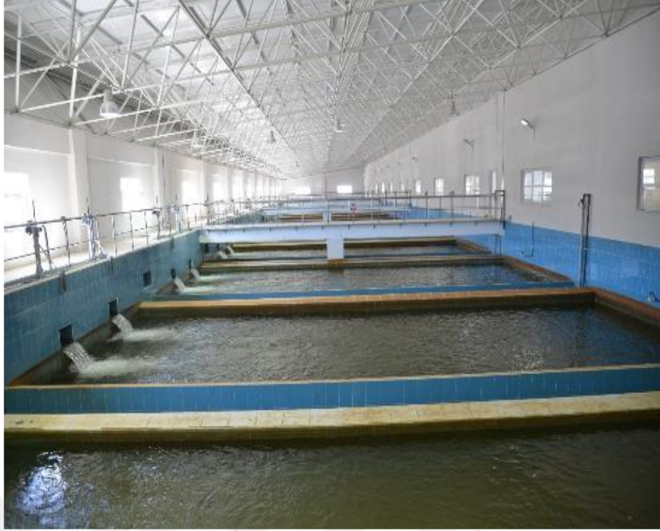
Şekil 3.9. Mavi Tünel İçme Suyu Arıtma Tesisi Filtre Ünitesi Havuzları
