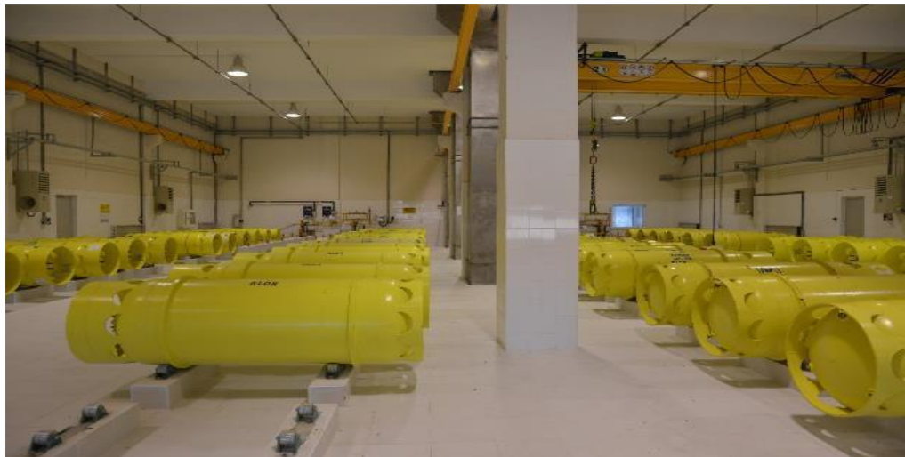
Şekil 3.10. Mavi Tünel İçme Suyu Arıtma Tesisi Klor Ünitesi
