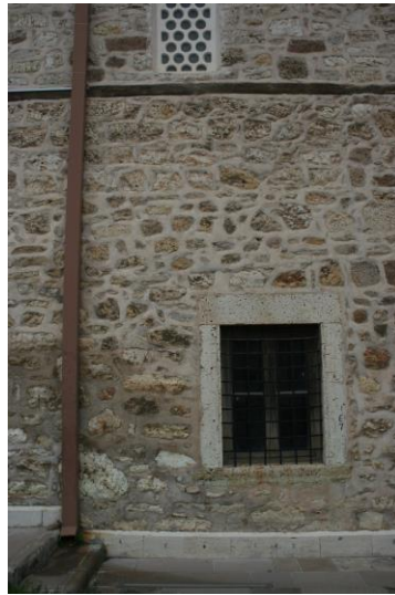
Şekil 4.41. Eşrefoğlu Cami batı cephesi taşlarındaki cephe kirliliği
