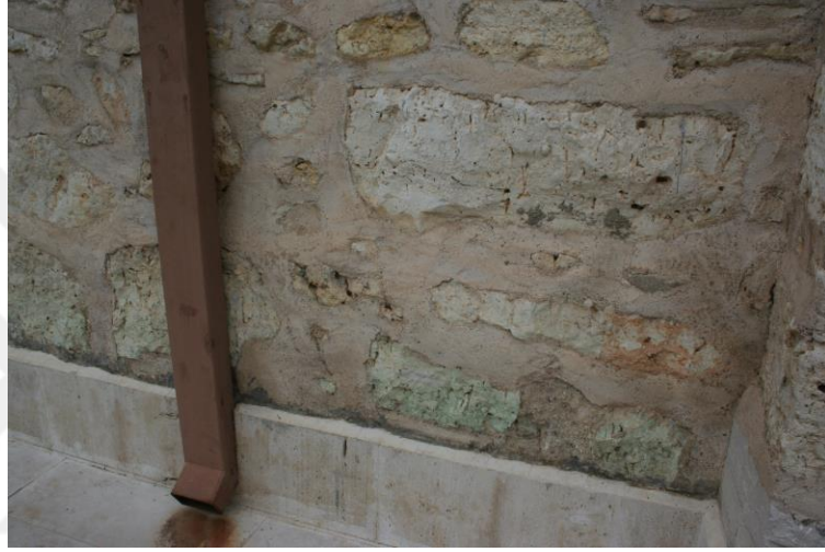
Şekil 4.37. Eşrefoğlu Cami güney cephesi oluk çevresi taşlarda görülen yeşillenmeler ve tretuvar taşında görülen renk değişimi
