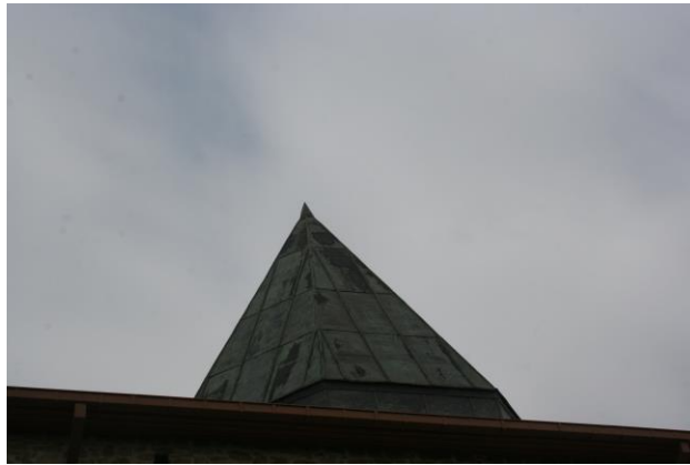
Şekil 4.38. Eşrefoğlu Cami mihrap önu kubbесi külahı korozyonu
