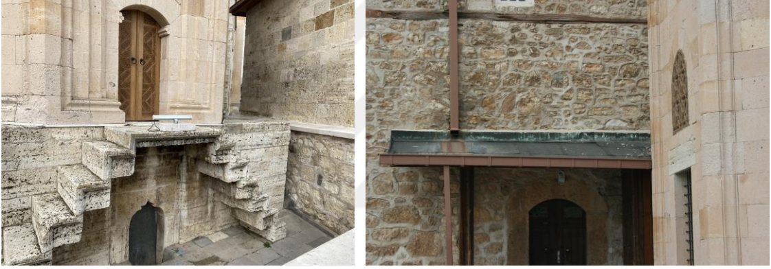
Şekil 4.33. ve Şekil 4.34. Eşrefoğlu Süleyman Bey Türbesi kaidesinde ve merdivenlerinde görülen malzeme bozulmaları ve sundurma saçakta görülen korozyon
