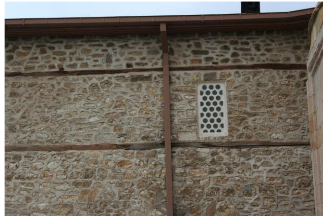
Şekil 4.35. Eşrefoğlu Camii doğu cephesi hatıllarında görülen soyulma ve liflenmeler
