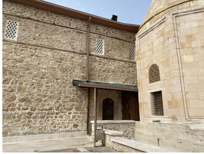
Şekil 4.32. Eşrefoğlu Camii doğu cephesi malzeme bozulmaları
