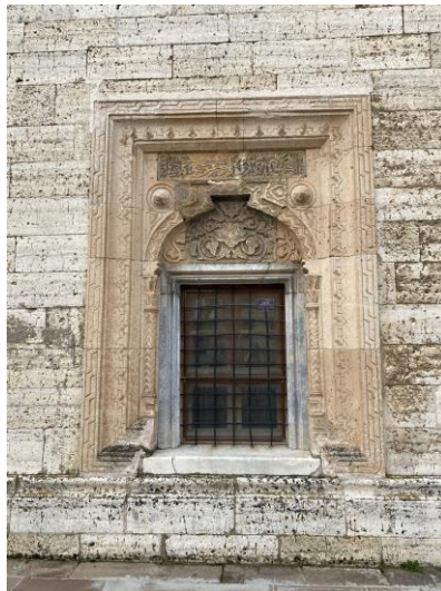
Şekil 4.25. Eşrefoğlu Cami kitabeli pencere bordürlerinde görülen kirlenmeler ve pencere parapetinde ki biyolojik oluşumlar
