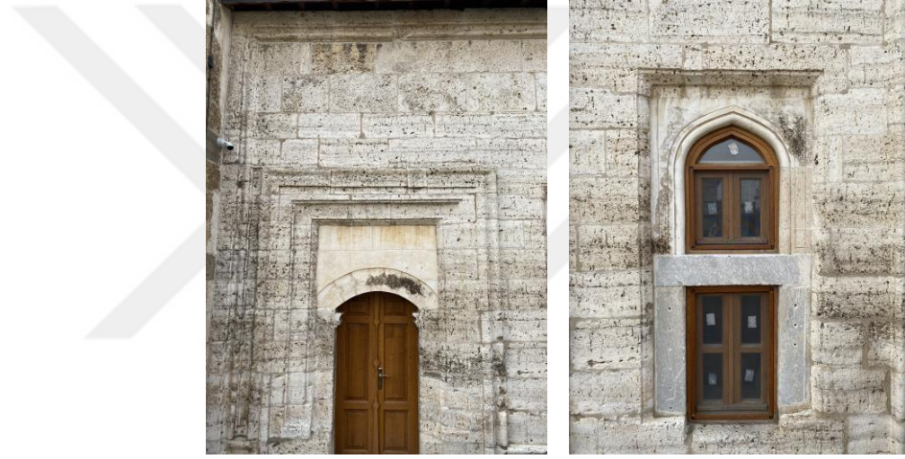
Şekil 4.26. ve 4.27. Eşrefoğlu Camii kütüphanesi kapı ve pencere bordürlerinde ve çevresinde görülen bozulmalar
