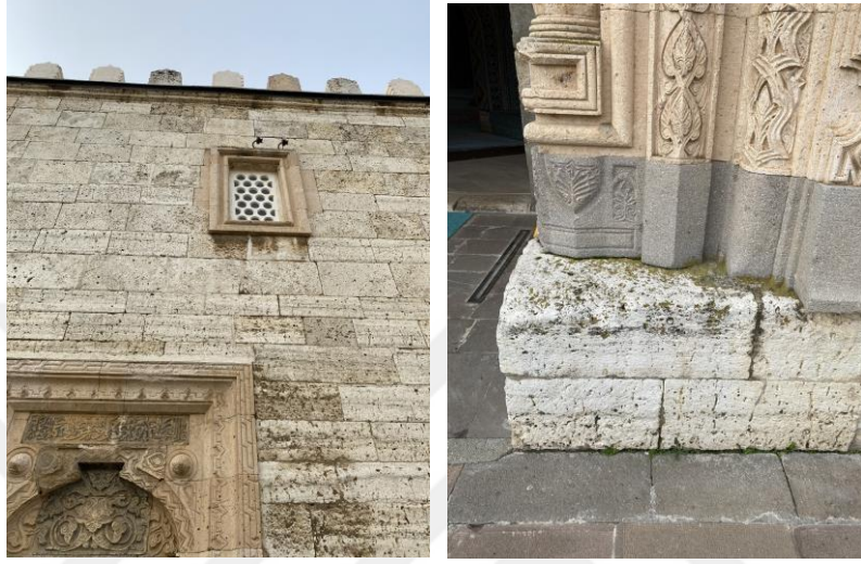
Şekil 4.23. ve Şekil 4.24. Eşrefoğlu Cami dendanlarında görülen kirlenmeler ve taç kapı kaidesinde görülen biyolojik oluşumlar
