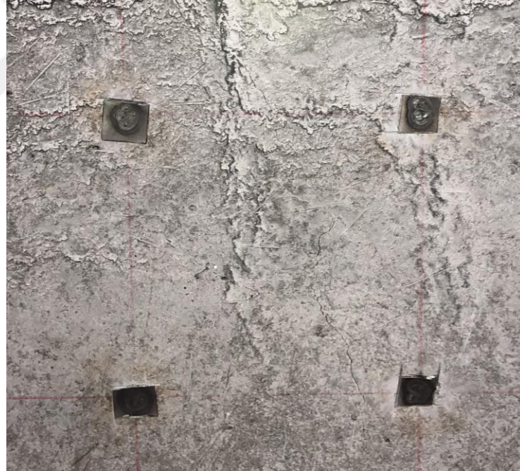
Şekil 4.83. SS3 numunesinde oluşan çatlak dağılımı
