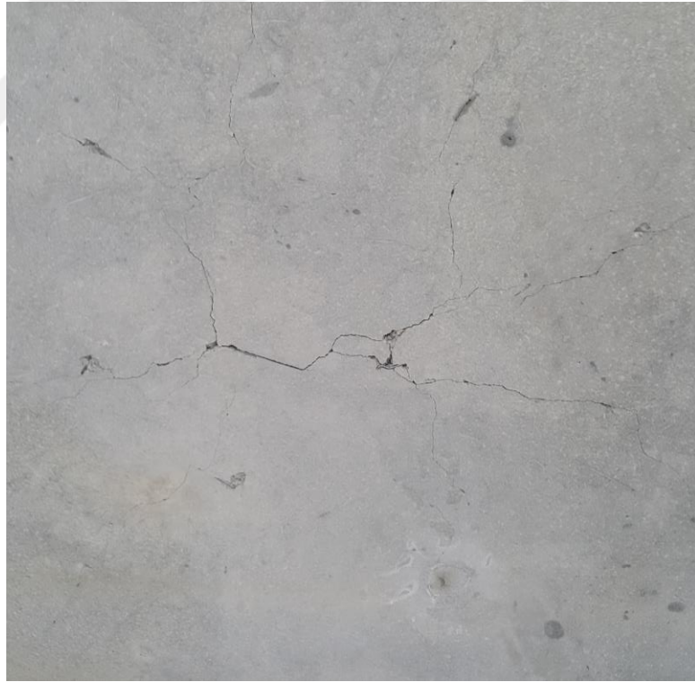
Şekil 4.55. SN2 numunesinde oluşan çatlak dağılımı
