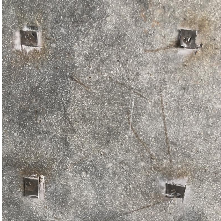
Şekil 4.79. SS2 numunesinde oluşan çatlak dağılımı
