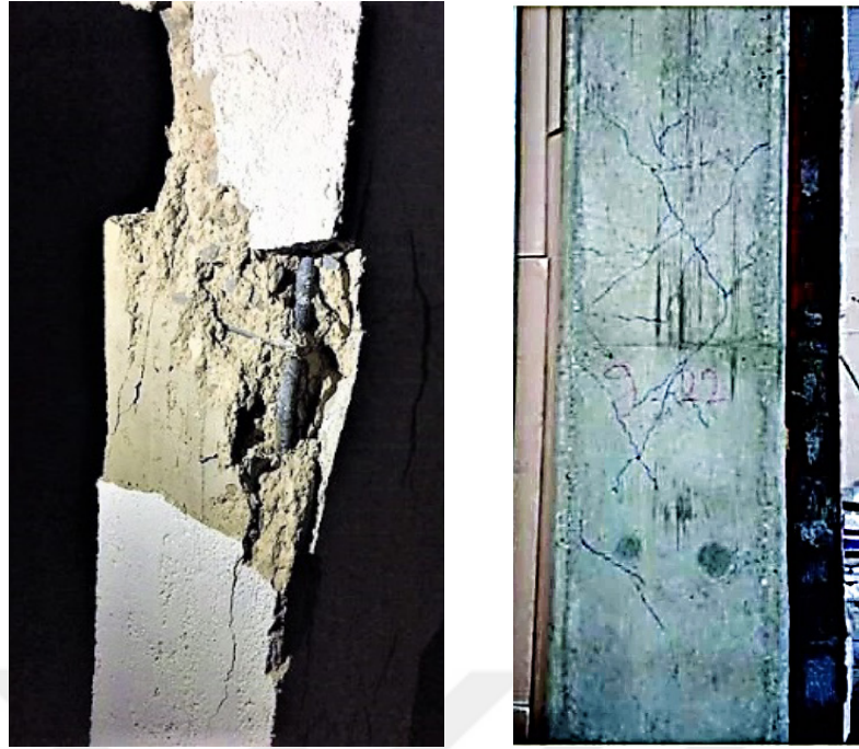
Şekil 1.17 Deprem etkisiyle kolonda meydana gelen burulma hasarı (Attarchian ve ark., 2020; THBB, 2020)
