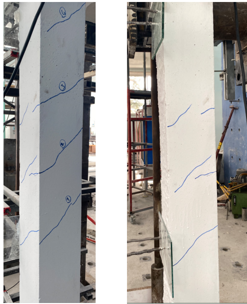
Şekil 4.27 SN-2 numunesinin burulma çatlama düzeyinde hasar durumu
