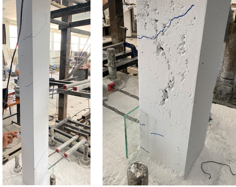
Şekil 4.2 SN-0 numunesinde meydana gelen ilk çatlaklar
