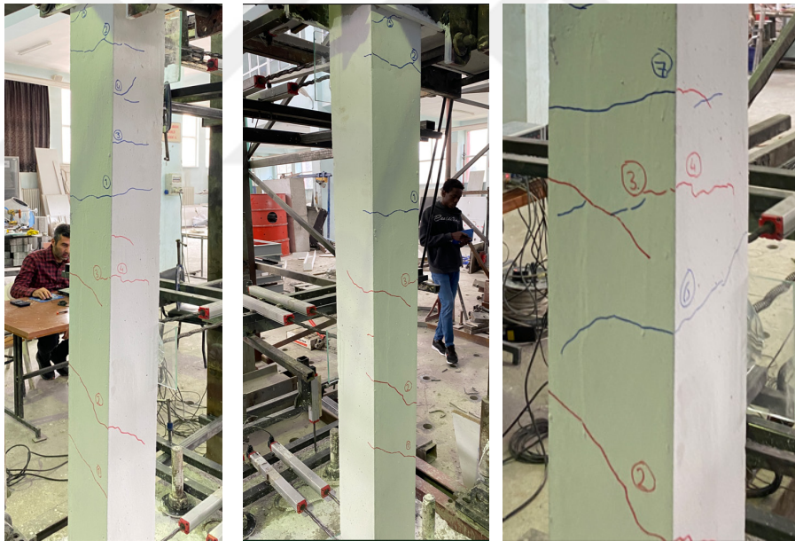
Şekil 4.13 SN-1 numunesinde meydana gelen ilk çatlaklar
