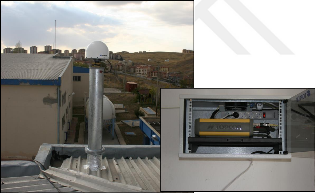
Şekil 4.2. Pursaklar Sabit İstasyonu ASKİ Arıtma Tesisleri - 2008
