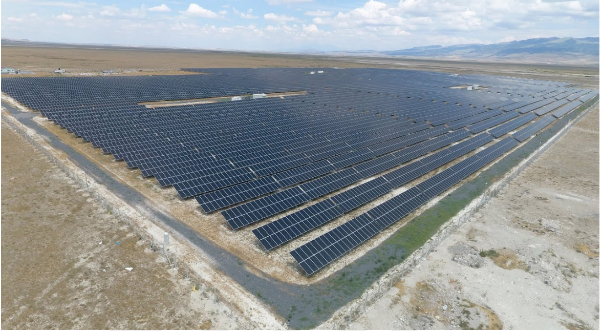
Şekil 1.3. Güneş Enerjisi Santrali
