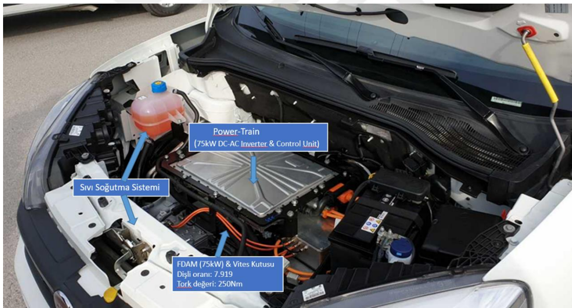
Şekil 4.137. 75 kW sıvı soğutmalı, tam kontrollü üç fazlı DA-AA dönüştürücü ve kontrol sisteminin Platform (binek otomobil) üzerine montaj edilmiş görseli
