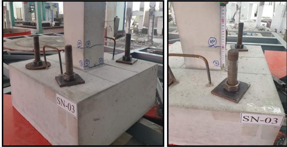
Şekil 6. 9 SN-03 numunesinde 10. Çevrim sonucu oluşan mikro çatlaklar
