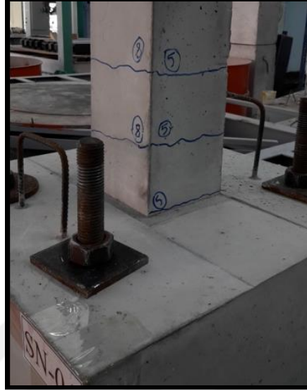
Şekil 6. 12 SN-04 numunesinde 10. Çevrim sonucu oluşan mikro çatlaklar
