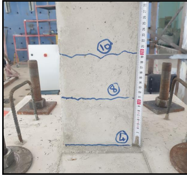
Şekil 6. 5 SN-01 numunesi sol yüzeyindeki kılcal çatlaklar
