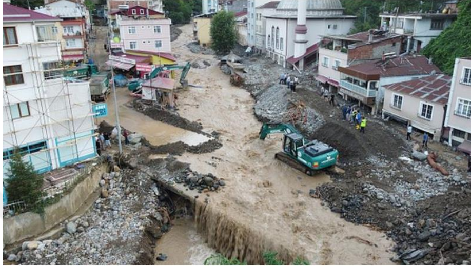
Şekil 2.7. 22 Ağustos 2020’de Giresun’da meydana gelen sel felaketinin yarattığı yıkım (URL 8)
