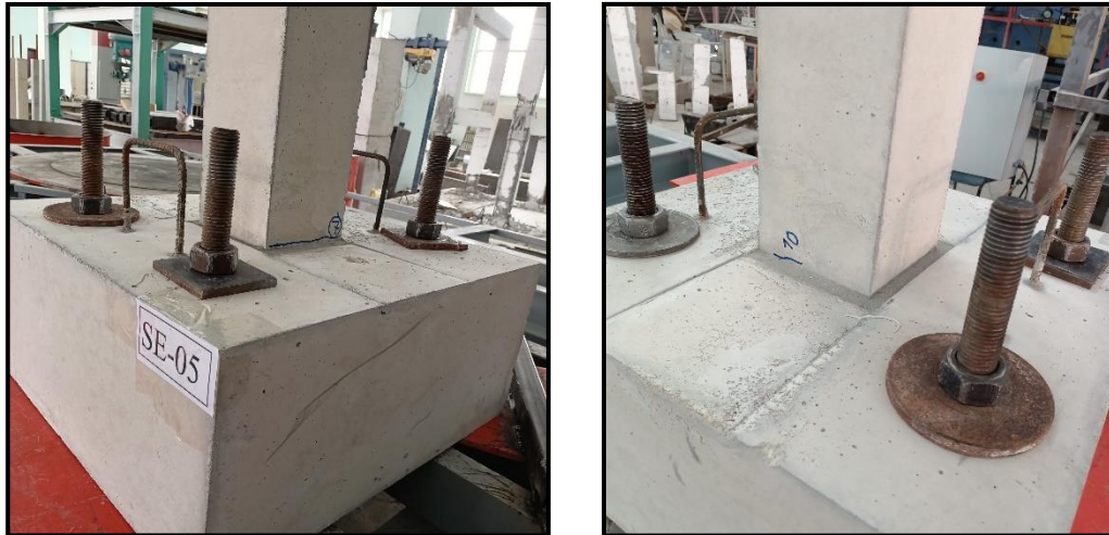
Şekil 6.30. SE-05 deney numunesinde test sonucunda oluşan çatlaklar
