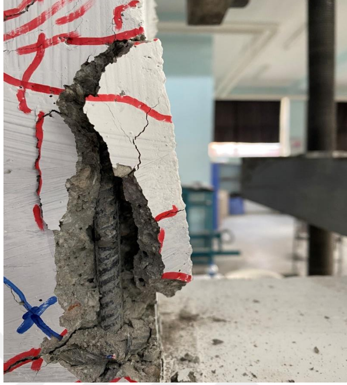
Şekil 4.11. Kirişin sağ kısmında kabuk betonun ayrılması
