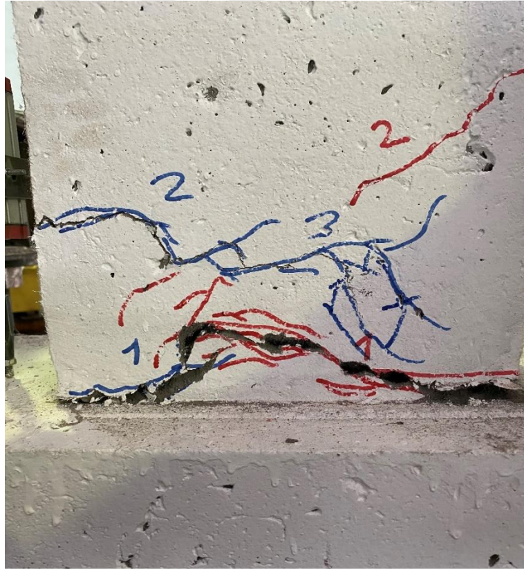
Şekil 4.48. AD3-ECC1-R0 elemanın deney sonundaki hasarları
