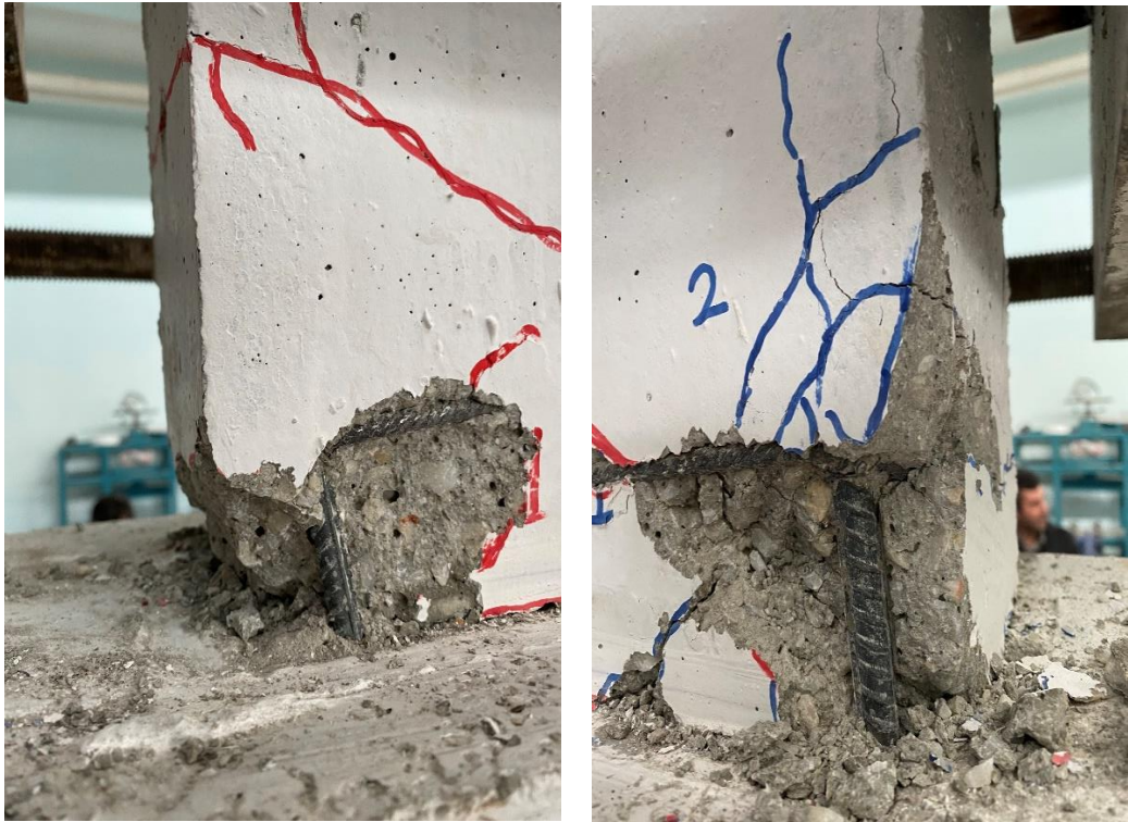
Şekil 4.4. AD1-ECC0-R1 elemanın deney sonundaki hasarları
