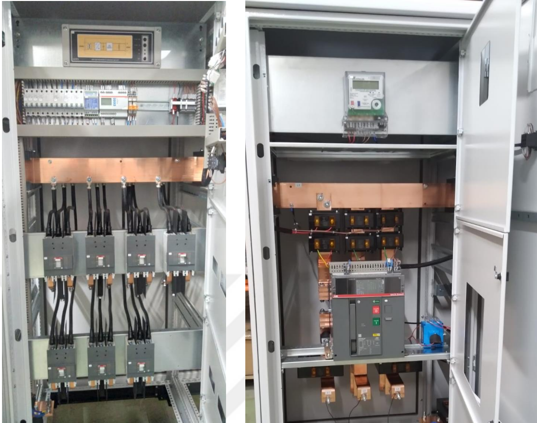
Şekil 6.6. GES panosu ve koruma ekipmanları
