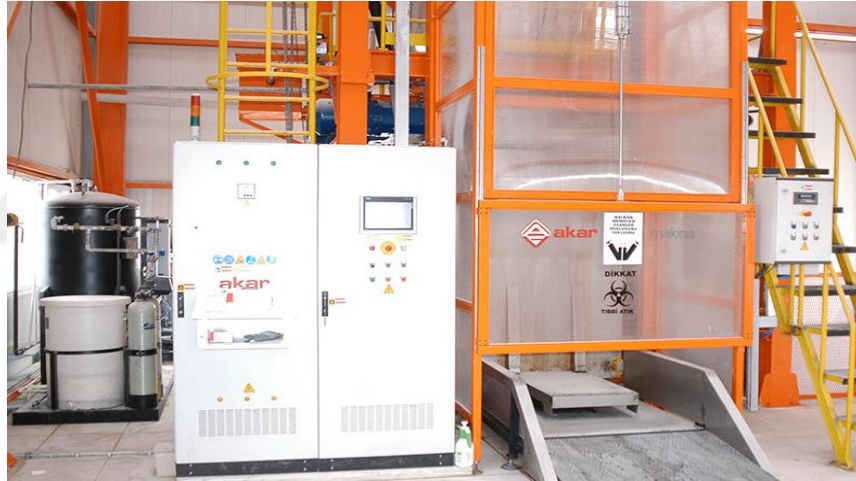
Şekil 4.2. Tıbbi atık sterilizasyon tesisindeki ekipmanlar (Biberici, 2017)
