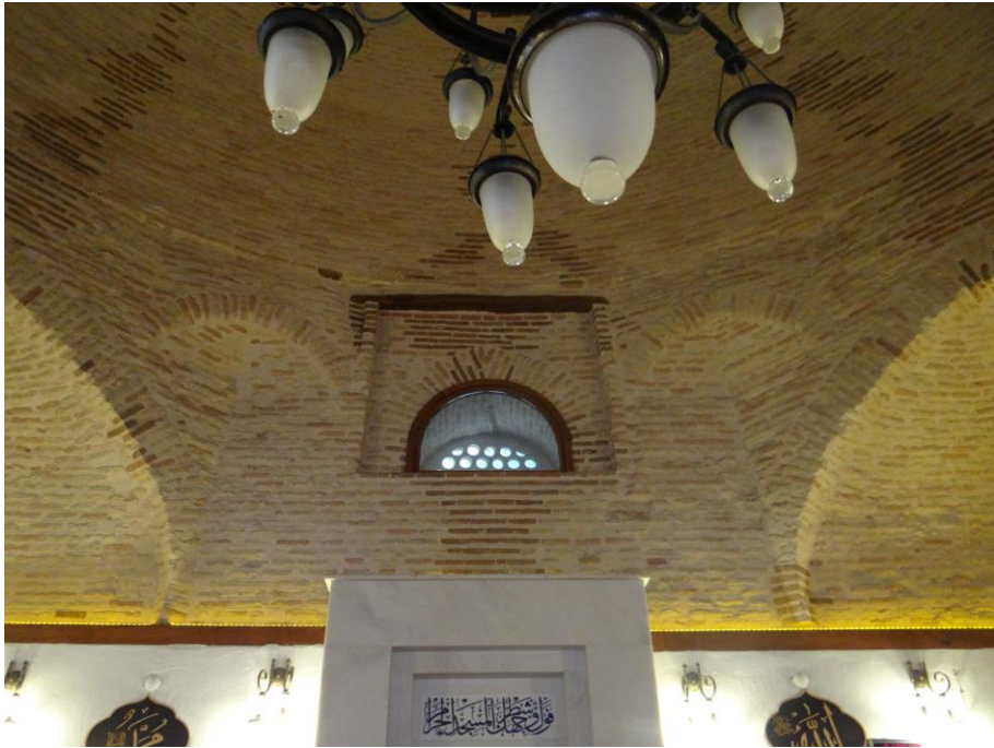
Şekil 5.47. Güney cephede yer alan küçük pencere üzerindeki ahşap hatıl
