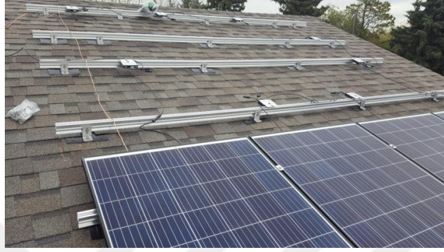
Şekil 3.17. Çatıda PV panellerin arkasına sabitlenen optimizer
