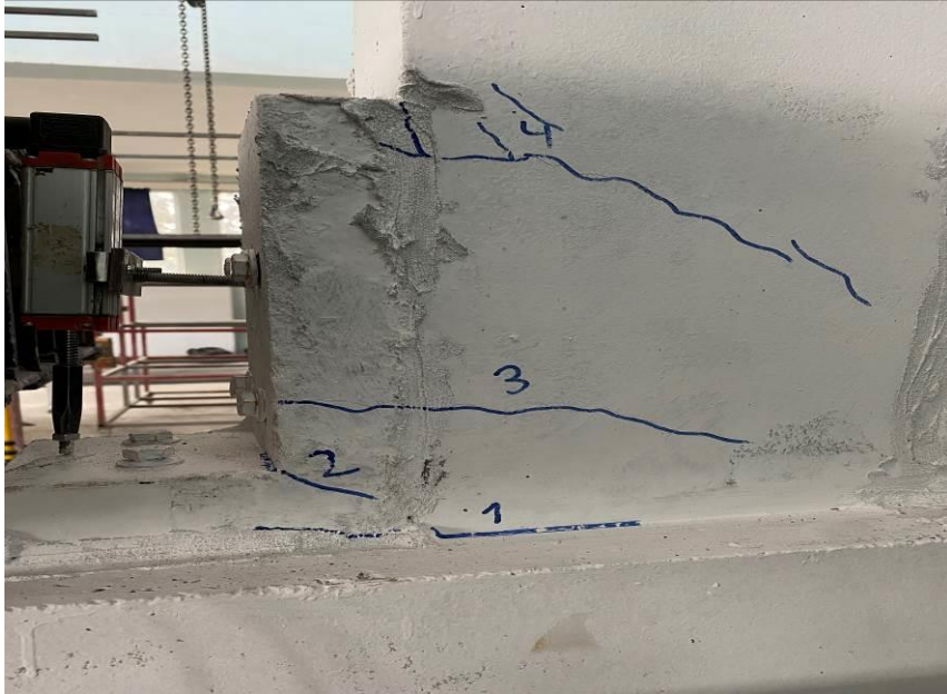
Şekil 4.64. RB- LDB2-SEW deney elemanın ilk çatlaklar
