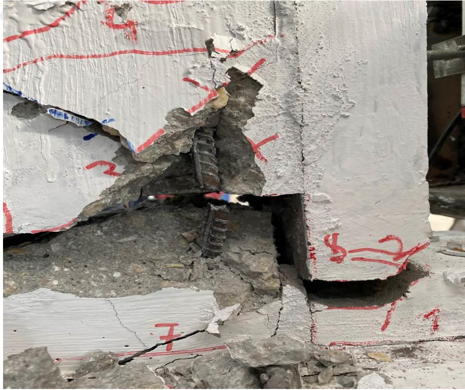
Şekil 4.46. RB- LDB1-LEW elemanında görülen donatı kopması ve panel birleşim yerinde meydana gelen ayrılma
