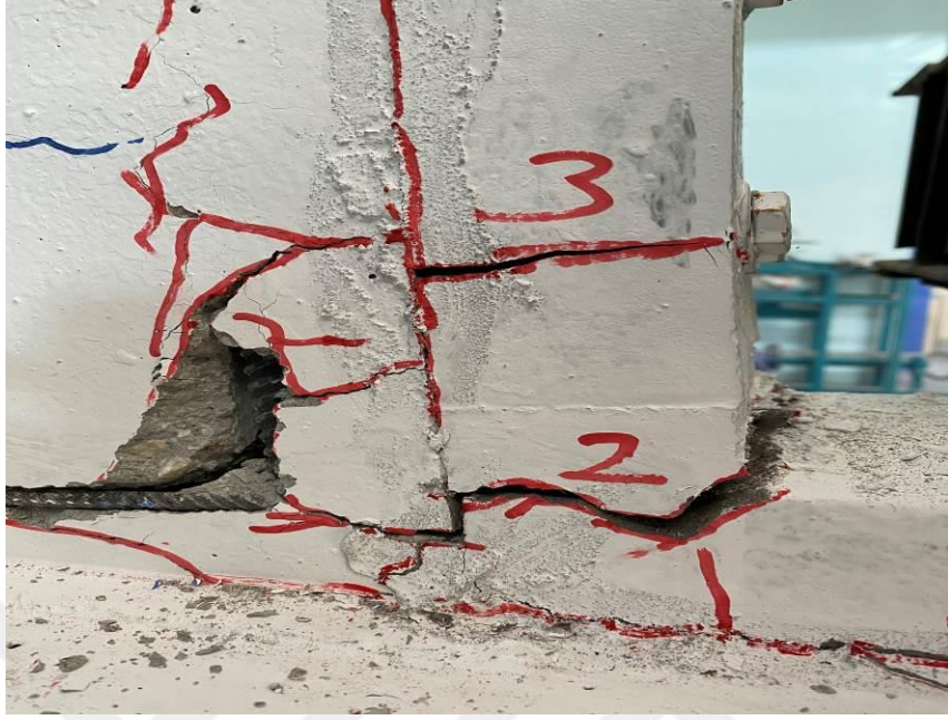
Şekil 4.35. RB-LDB1-LE deney elemanında ve güçlendirme panelin birleşim yerinde oluşan hasarlar.
