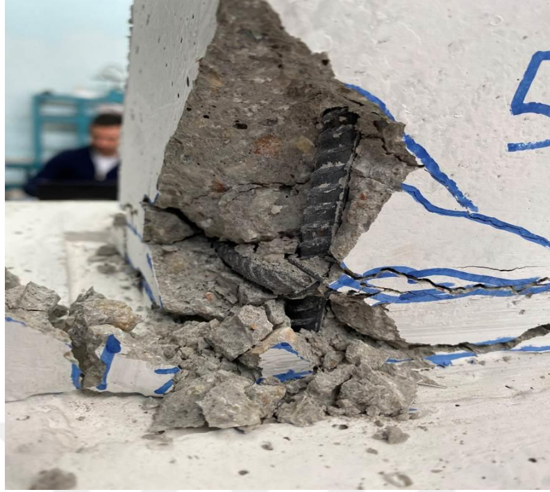
Şekil 4.76. RB- LDB2-LE deney elemanında dökülen paspayı ve görünen etriye
