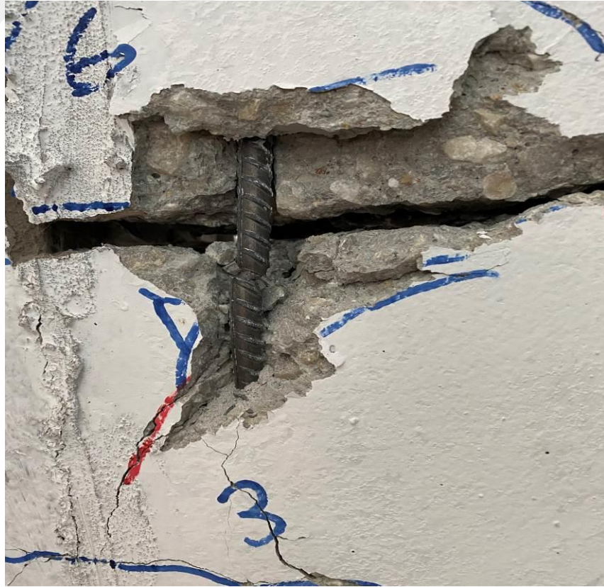
Şekil 4.67. RB- LDB2-SEW deney elemanında donatı kopması
