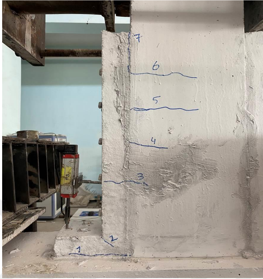
Şekil 4.44. RB- LDB1-LEW deney elemanında oluşan ilk çatlaklar
