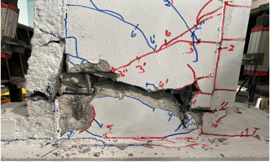
Şekil 4.88. RB- LDB2-LEW elemanında görülen donatı kopması ve panellerdeki ciddi hasarlar
