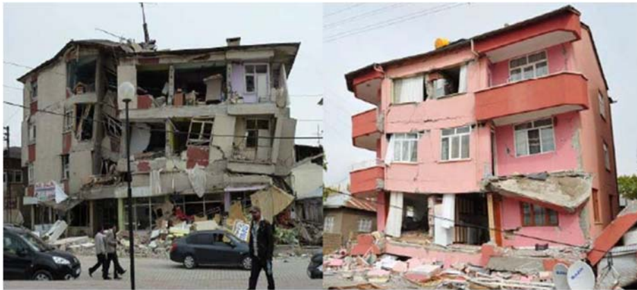
Şekil 3.21. Van depreminde yeterli yanal rijitliğe sahip olmayan binalarda gözlenen hasarlar (İKÜ-CE, 2011)
