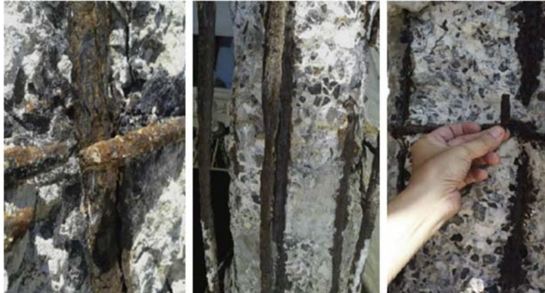
Şekil 3.24. Korozyona maruz kalmış donatı örnekleri (Taşdemir ve ark., 2000)
