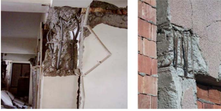
Şekil 3.15. Sargısız kolon-kiriş birleşim noktası hasarları (Topçu, 2019)
