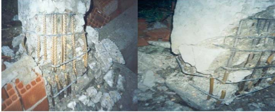
Şekil 3.17. 2011 Van depreminde kolon sarılma bölgelerinde meydana gelen hasarlara örnekler (İKÜ-CE, 2011)
