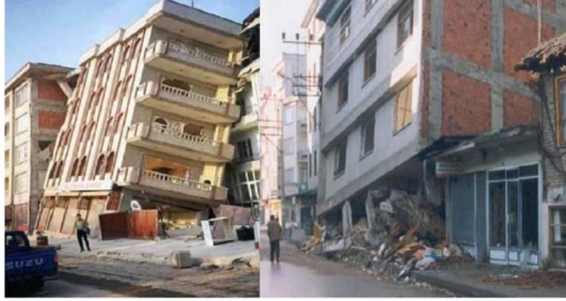
Şekil 3.8. 2011 Van depreminde yumuşak kat düzensizliğine bağlı oluşan hasarlar (İKÜ-CE,2011)
