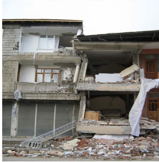
Şekil 3.11. Çekiçleme etkisi sebebiyle göçen bir bina (Öztürk, 2015)
