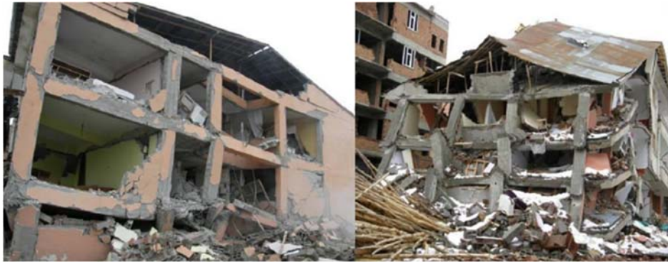
Şekil 3.20. 2011 Van depreminde plastik mafsallaşma yaşanan binalar (İKÜ-CE, 2011)
