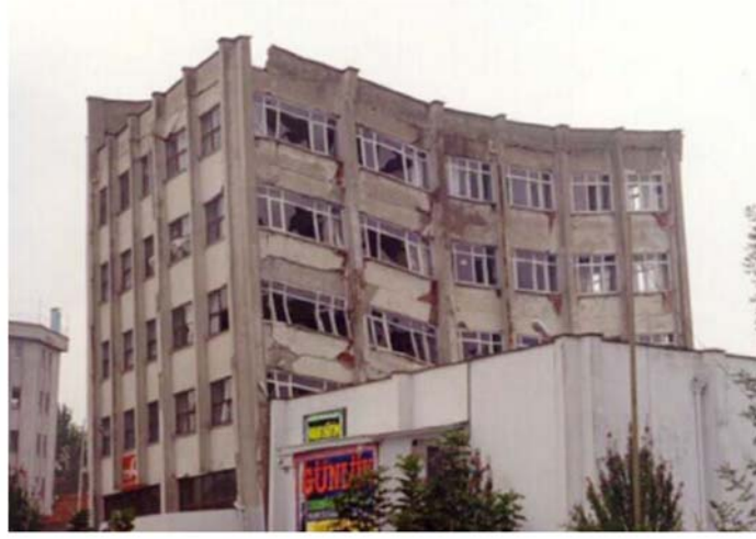
Şekil 3.3. 1999 Kocaeli depremi sonrasında burulma hasarı görülen kamu binası (Çağatay ve ark, 2007)
