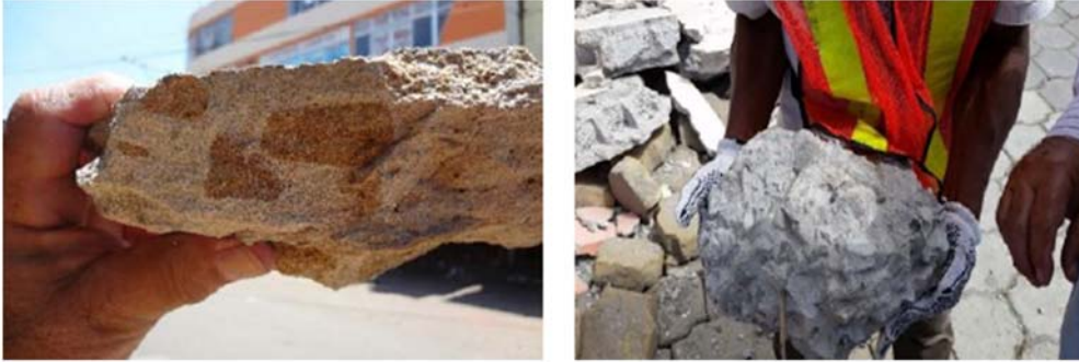
Şekil 3.18. Segregasyona uğramış ve uygun agrega seçimi yapılmamış beton numuneleri (Yepez, 2017)
