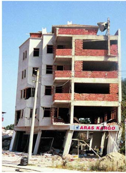
Şekil 3.7. 1999 Kocaeli depremi zayıf kat hasarı (Sezen ve ark, 2000)
