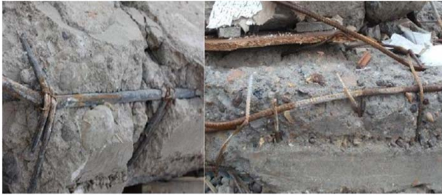
Şekil 3.16. 2011 Van depreminde donatı detaylandırma hatalarına bağlı hasarlara örnekler (İKÜ-CE, 2011)
