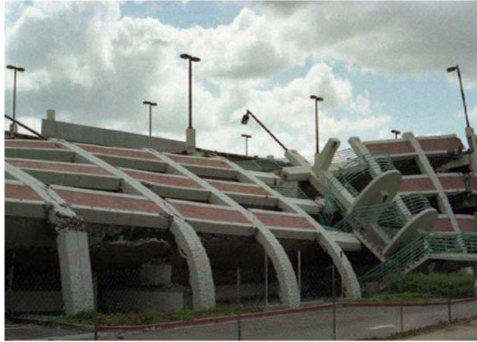
Şekil 3.4. 1994 Northridge depreminde meydana gelen burulma hasarı (FEMA-454, 2006)
