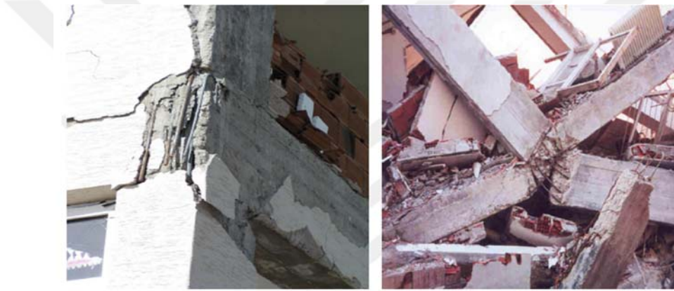
Şekil 3.13. Kolon-kiriş birleşim bölgelerinde oluşan hasarlar (Gürer, 2012)
