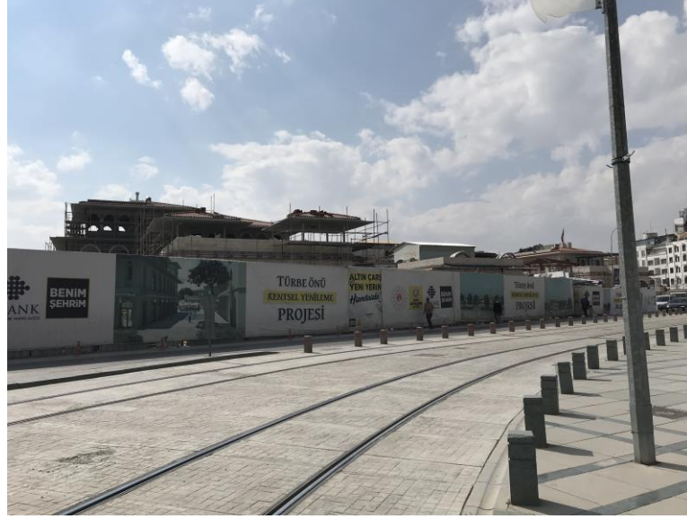
Şekil 4.130. Mevlana Meydanı kentsel yenileme projesi kapsamında yıkılan Mevlana Katlı Otoparkı ve işyerleri
