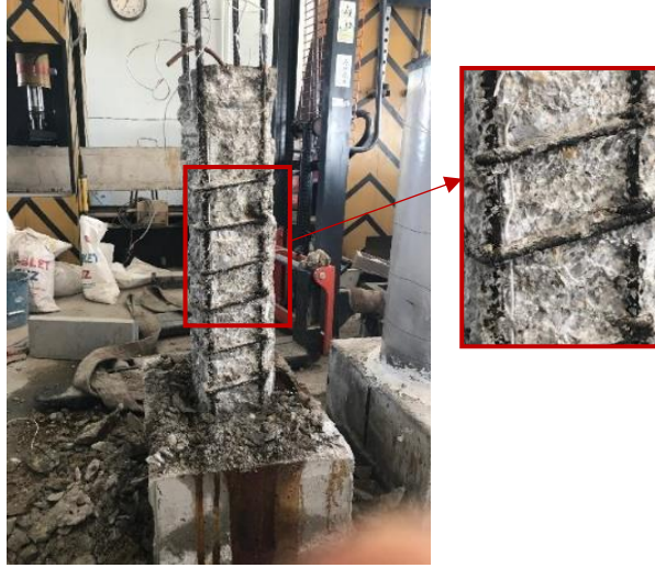
řekil 10: SV isimli numunede beton örtülerinin sıyrılması ve korozyon dağılımı
