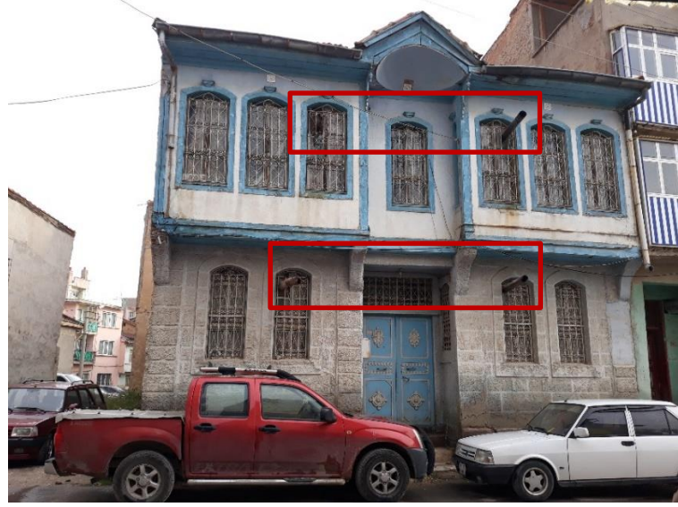
Şekil 5.9. Kantaroğlu Sokak No:18 pencerelere muhdes boruların eklenmesi
