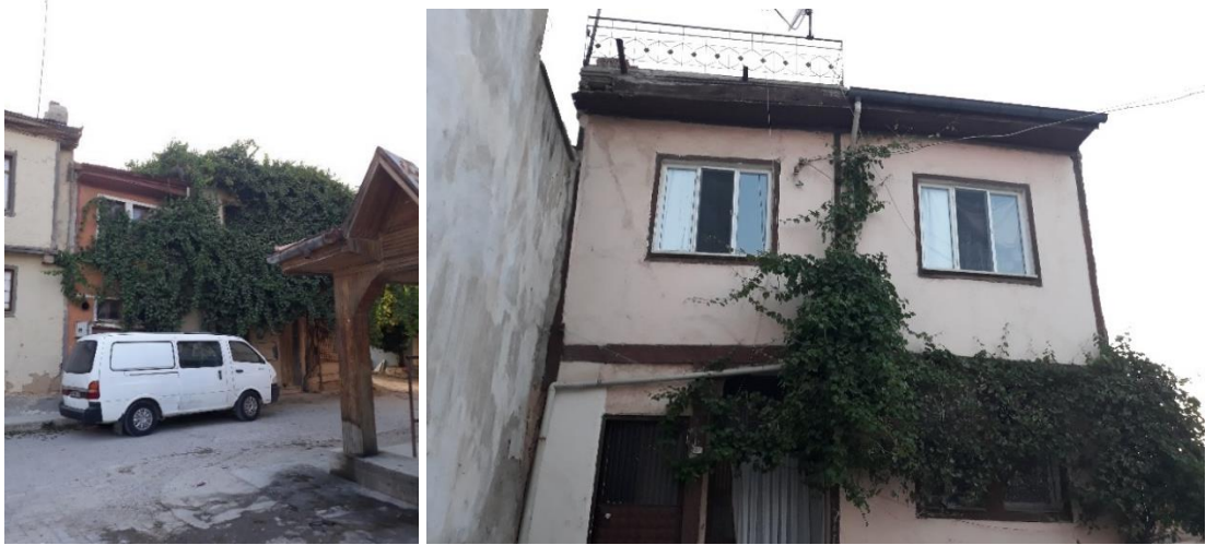
Şekil 5.10. Emir Sultan Sokak ve Kırklar Sokakta cephe yüzeyinde görülen bitkilenmeler
