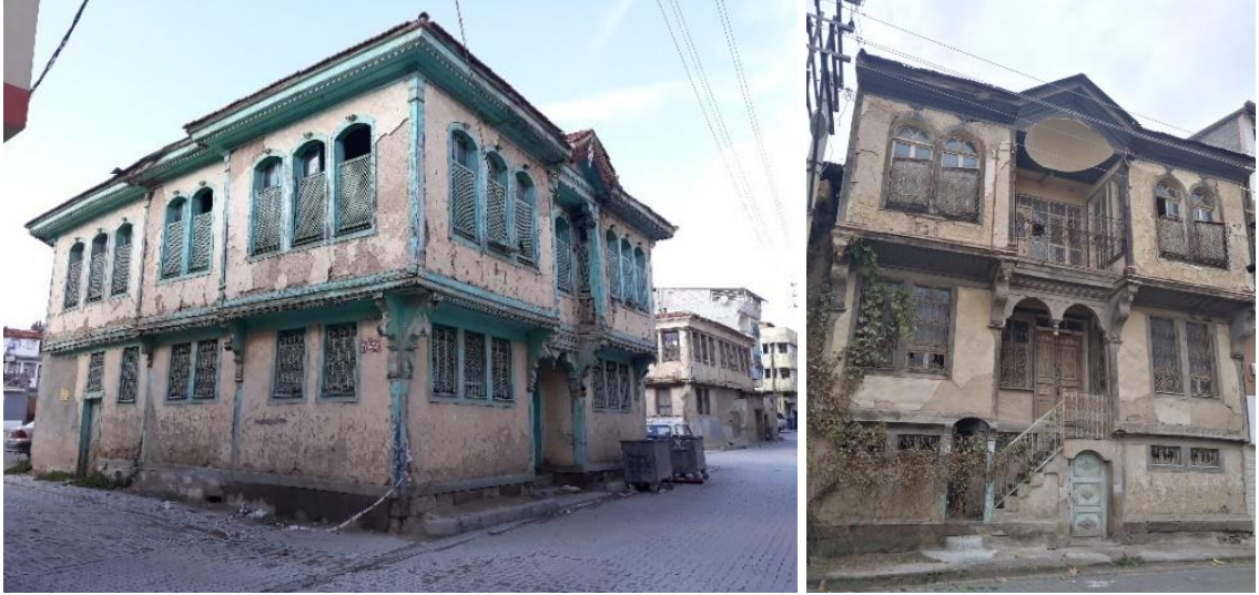
Şekil 6.7. Cilalıoğlu Sokakta cephede onarım gerektiren yapı örneği
