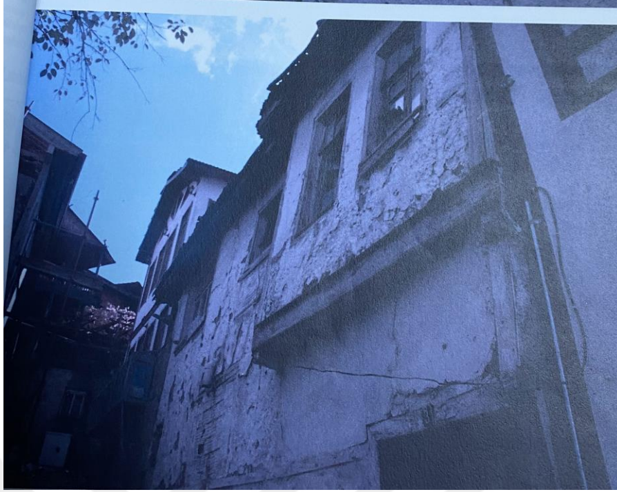
Şekil 4.43. Çıkma ahşaplarında ve pencerelerde görülen bozulmalar (Ankara Koruma Kurulu 2021)
