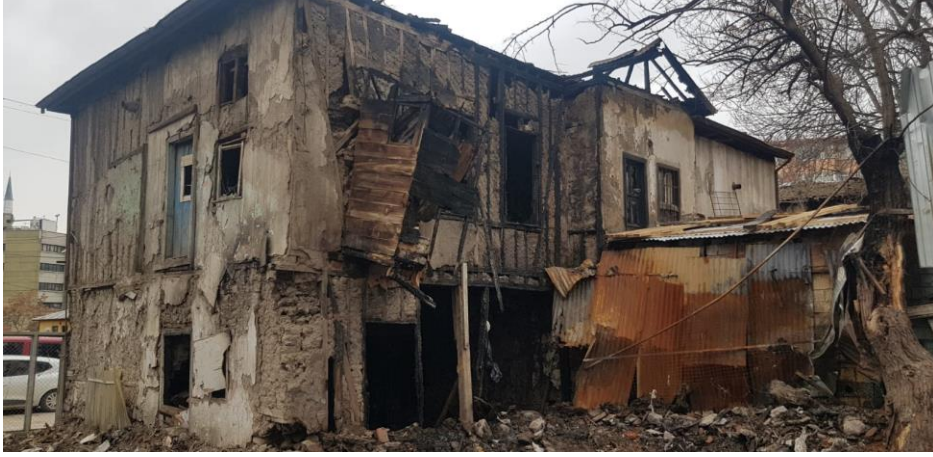
Şekil 4.34. 145 ada 9 parselde yer alan yıkım kararı verilen yapı (Ankara Koruma Kurulu 2021)
