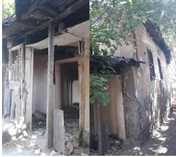
Şekil 4.27. Taşıyıcı sistemde meydana gelen bazı hasarlar (Ankara Koruma Kurulu 2021)
