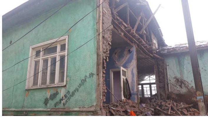
Şekil 4.36. Yıkımı gerçekleştirilen yapıda görülen vandalizm izleri (Ankara Koruma Kurulu 2021)
