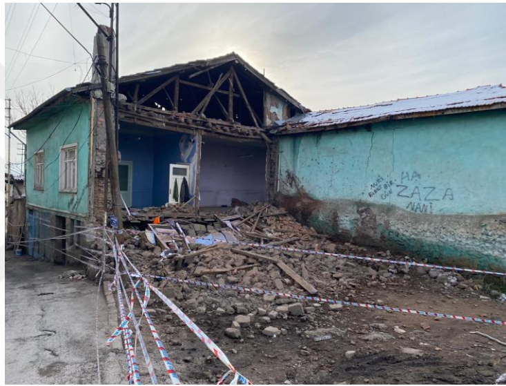
Şekil 4.37. Yıkımı gerçekleştirilen yapıda görülen vandalizm izleri (Ankara Koruma Kurulu 2021)
