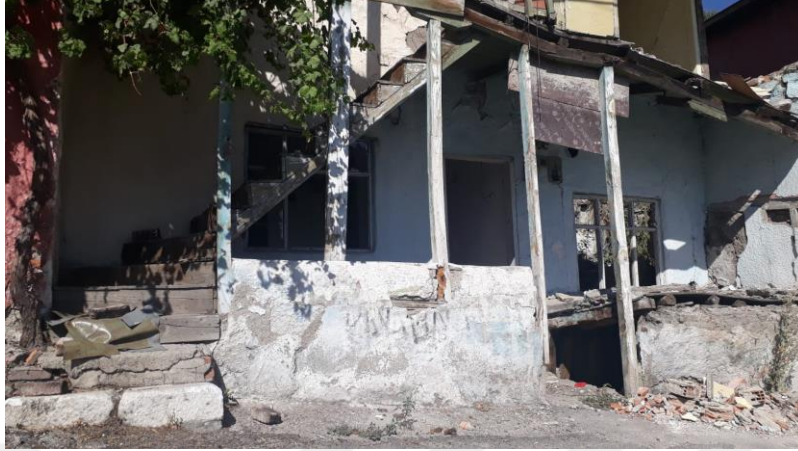
Şekil 4.45. Zamanla çöken üst kat döşemesi ve merdiven
