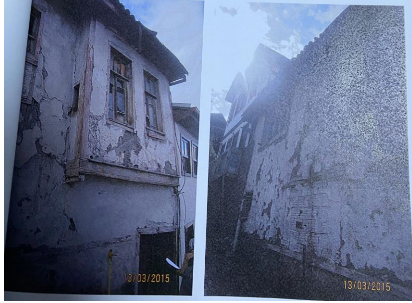
Şekil 4.33. 486 ada 4 parselde yer alan tescilli yapıda meydana gelen yıpranmalar (Ankara Koruma Kurulu 2021)
