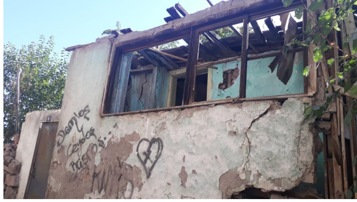
Şekil 4.29. Ahşap pencerelerde nem etkisiyle meydana gelen bozulmalar (Ankara Koruma Kurulu 2021)
