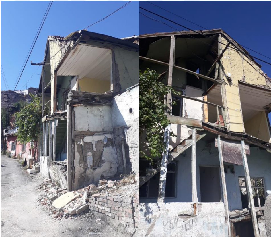
Şekil 4.46. Ağır hasar gören ve boşalan duvarlar
