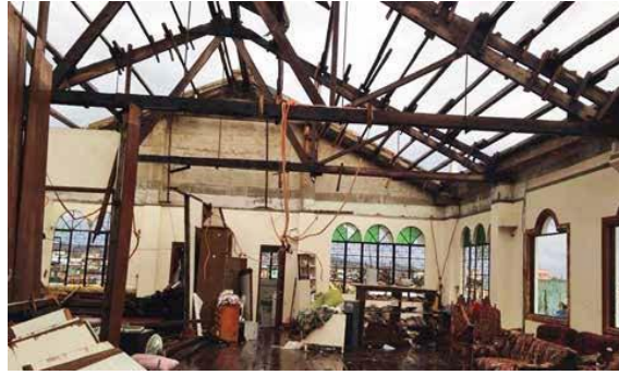
Şekil 2.19. Filipinler, 2013, Tarihi bina şiddetli yağmur ve rüzgarlar nedeniyle hasar görmüştür. (ICOMOS, 2016)
