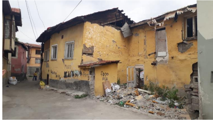
Şekil 4.28. Çatıda nem etkisiyle çürüyen iskelet (Ankara Koruma Kurulu 2021)
