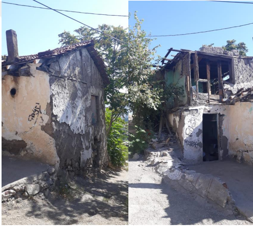
Şekil 4.60. Yıkılmış duvarlar (Ankara Koruma Kurulu 2021)
