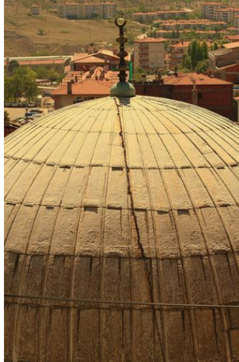
Şekil 4. 12. Kubbede meydana gelen hasar örneği
