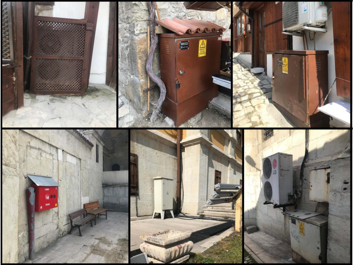
Resim4 11 Klimalar ve elektrik panoları (Orijinal, 2021)
