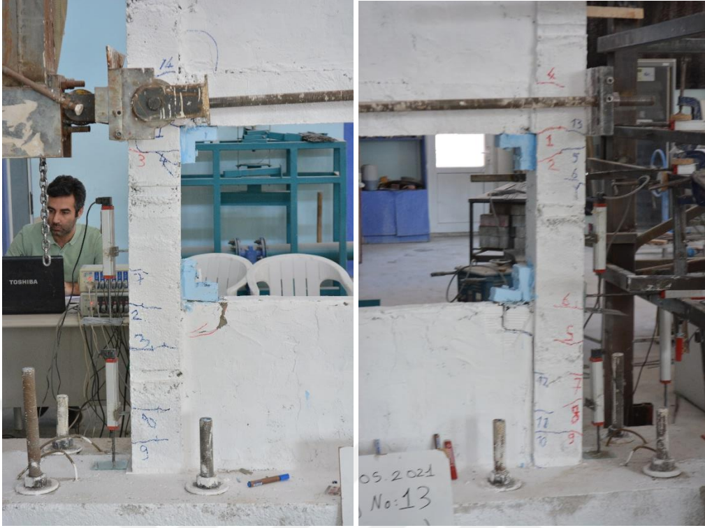
Şekil 4.102. R4-S1 numunesinin +4 çevriminde oluşan çatlaklar
