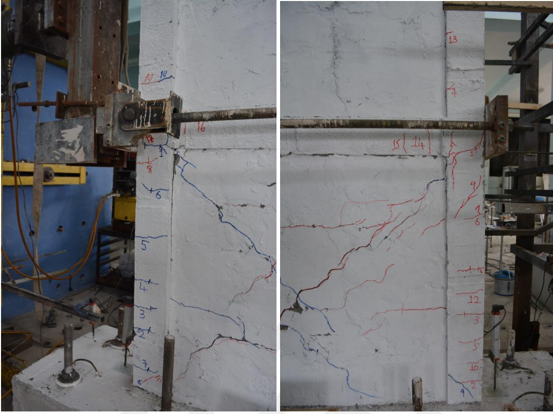
Şekil 4.22. R2 numunesinin -4 çevriminde oluşan çatlaklar
