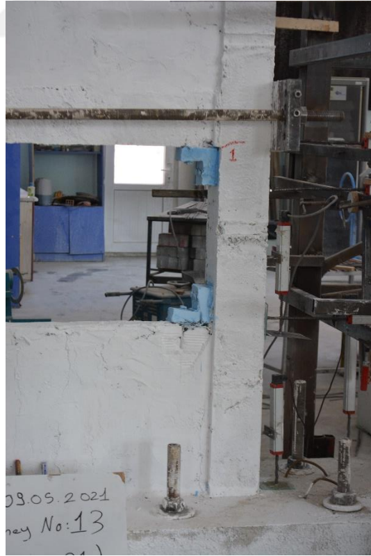
Şekil 4.97. R4-S1 numunesinin -1 çevriminde oluşan çatlaklar
