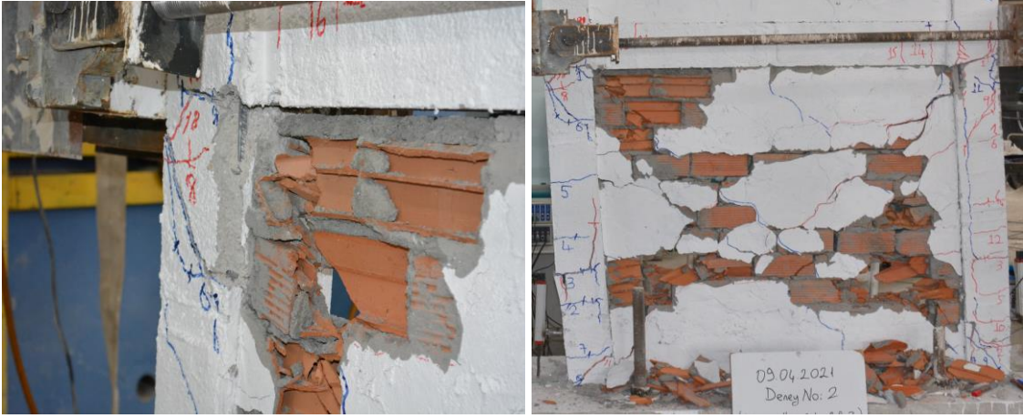
Şekil 4.224. Dolgu duvar hasarları (R2 numunesi)
