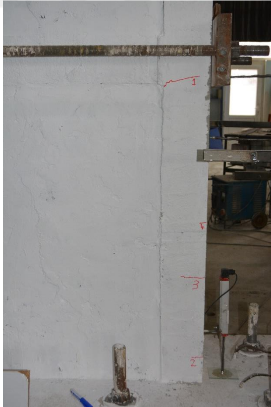
Şekil 4.17. R2 numunesinin -1 çevriminde oluşan çatlaklar
