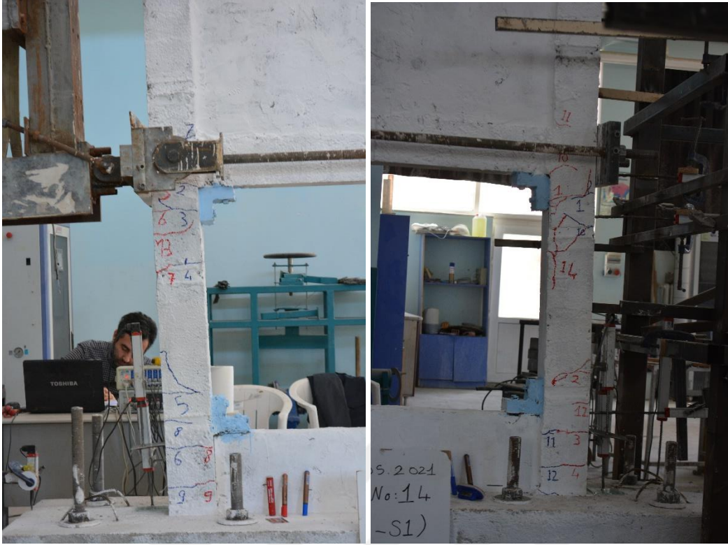
Şekil 4.116. R5-S1 numunesinin -4 çevriminde oluşan çatlaklar
