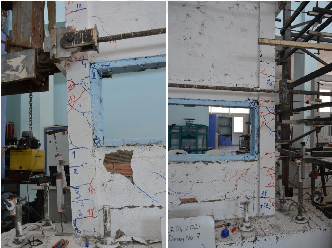
Şekil 4.199. R4-S3 numunesinin -5 çevriminde oluşan çatlaklar
