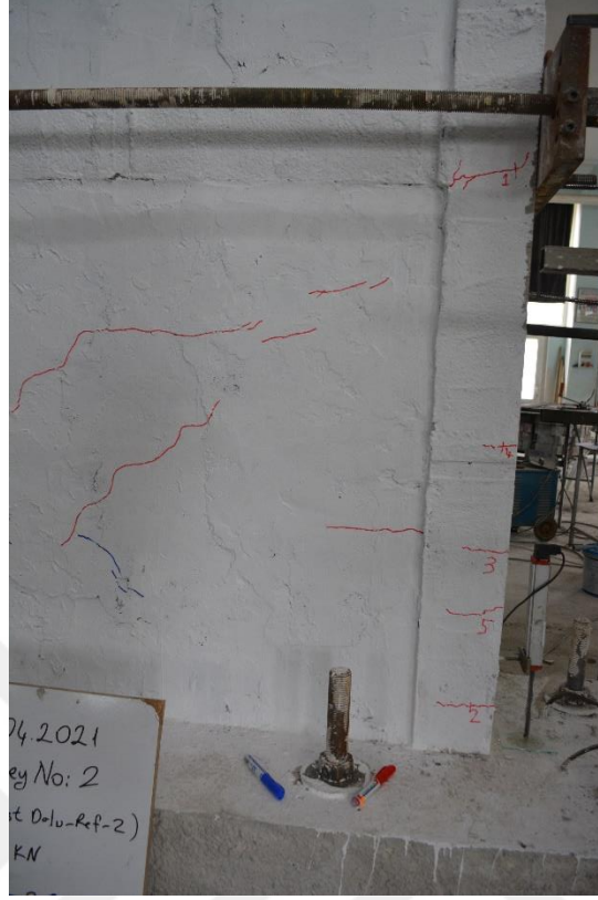
Şekil 4.18. R2 numunesinin -2 çevriminde oluşan çatlaklar
