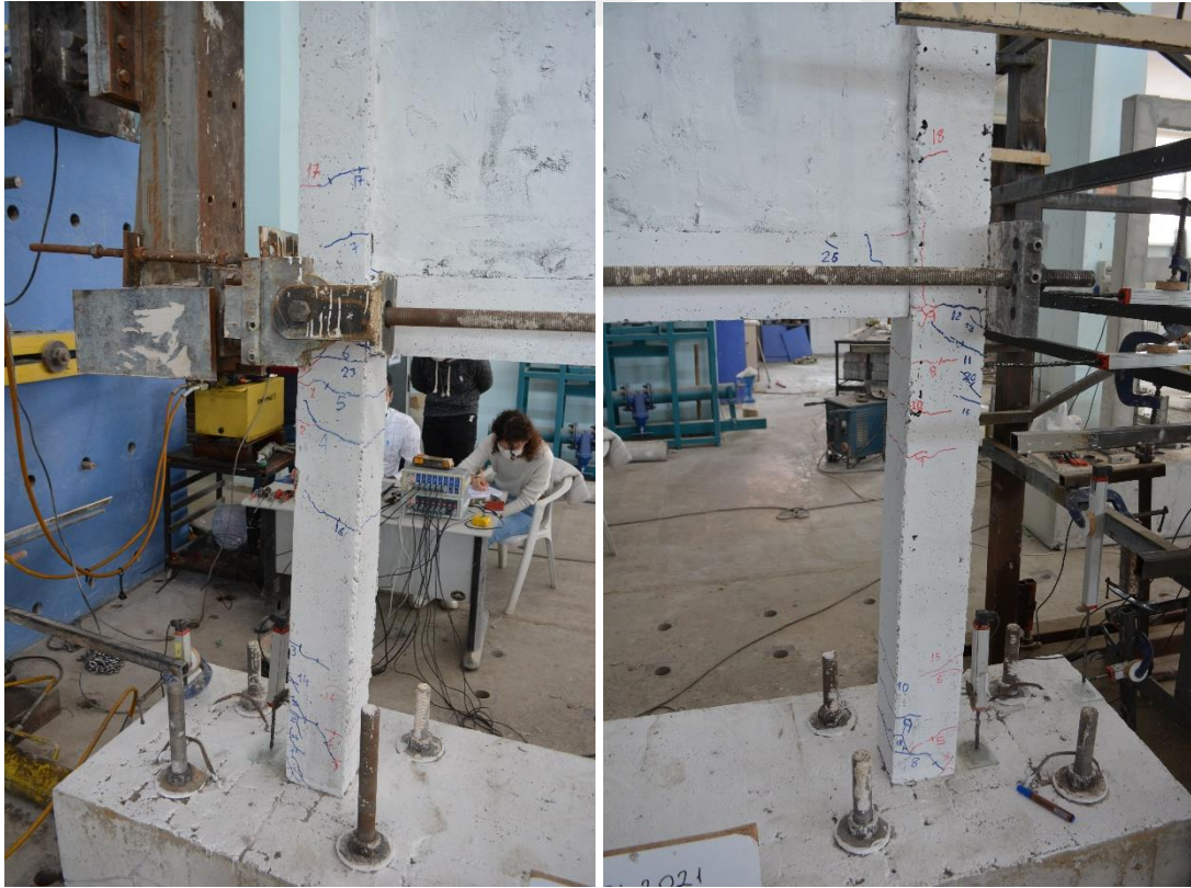
Şekil 4.7. R1 numunesinin +4 çevriminde oluşan çatlaklar
