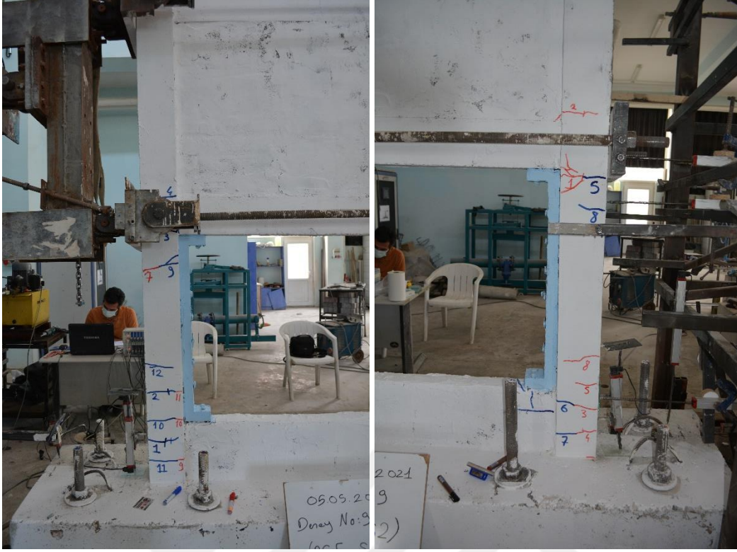
Şekil 4.163. R5-S2 numunesinin -3 çevriminde oluşan çatlaklar
