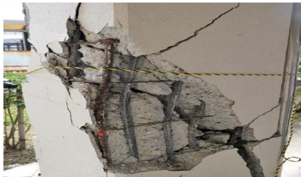
Şekil 4.1 Kolon kesme çatlağı örneği
