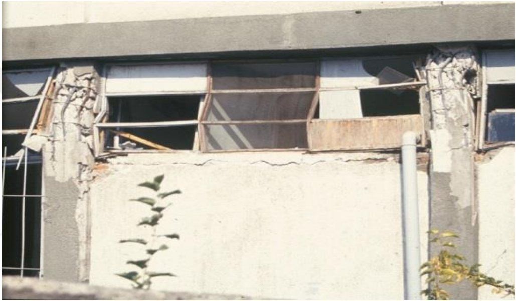
Şekil 4.3 Kısa kolon hasarı
