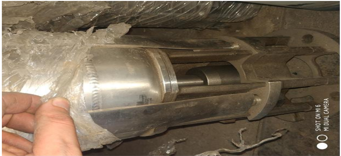
Şekil 7. Yeni dalgıç pompa
