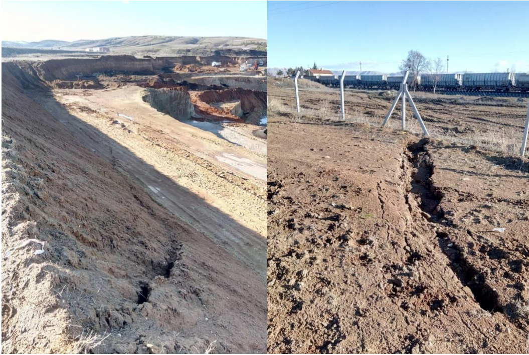
Şekil 2. Sahada görülen çekme çatlakları
