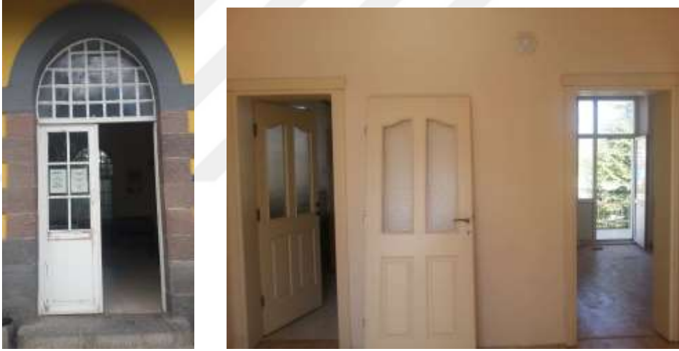
Şekil 5.19. Garın gişesi bölümüne giriş kapısı solda ve sağda lojman sofasındaki değiştirilen kompozit kapılar (Özmertyurt, 03.05.2018).
