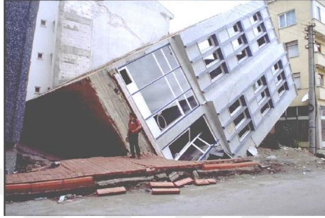
Şekil 5.12. “Deprem kuvvetine maruz kalmış binanın yıkılma sebebi ne olabilir?” sorusu görseli, Adapazarı’nda yer alan yapı zemin sıvılaşması ve temel yetersizliğinden dolayı yıkılmıştır (Özgen, 2002)
